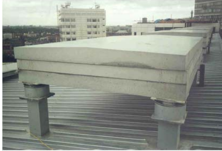
Şekil 4.4 Bina tepesine yerleştirilmiş tipik atalet bloğu
