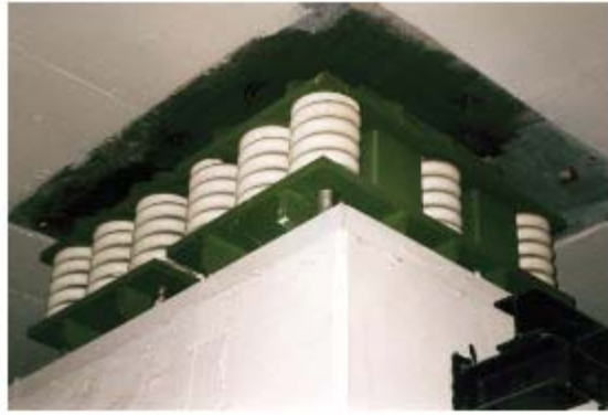
Şekil 5.6 Türbin temelinin altına yerleştirilen entegre viskoz sönümleyicili yay sistemi
