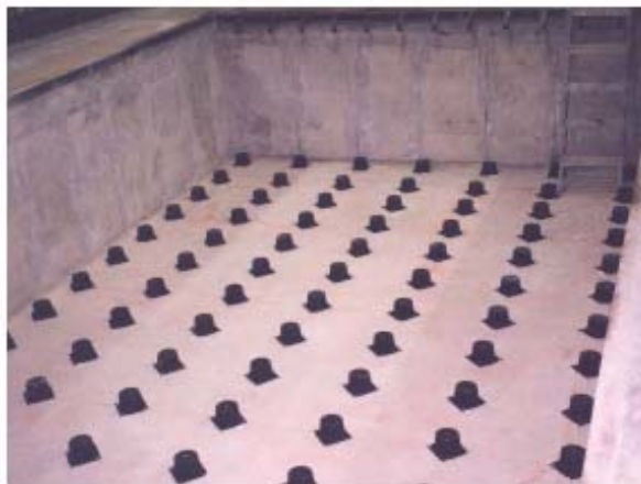
Şekil 4.1 Dinamik Ekipman Temeli altına uygulanmış elastomerik izolatörler
