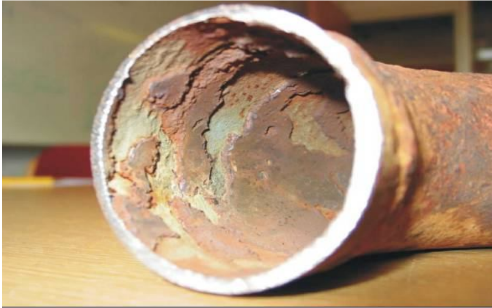
Şekil 3.12. CO 2 üretim sisteminde karbonik asidin neden olduğu ağır korozyon-[9]
