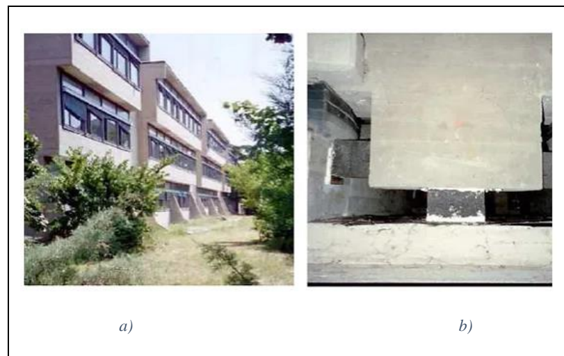
Şekil 3.1: 1969 yılında yapılan dünyanın ilk kauçuk sismik yalıtımlı binası. a) genel görünüm, b) izolatör görünüşü.
