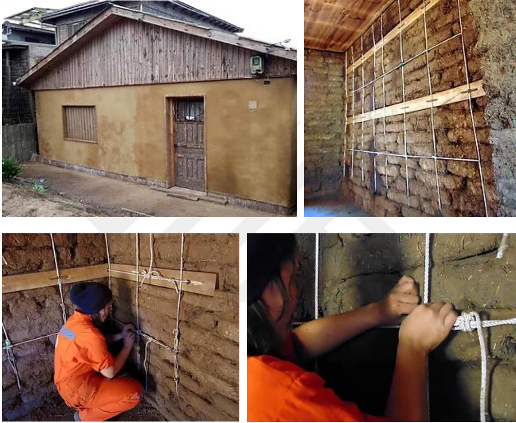
Şekil 3.38: Kerpiç ev güçlendirilmesi [124].
