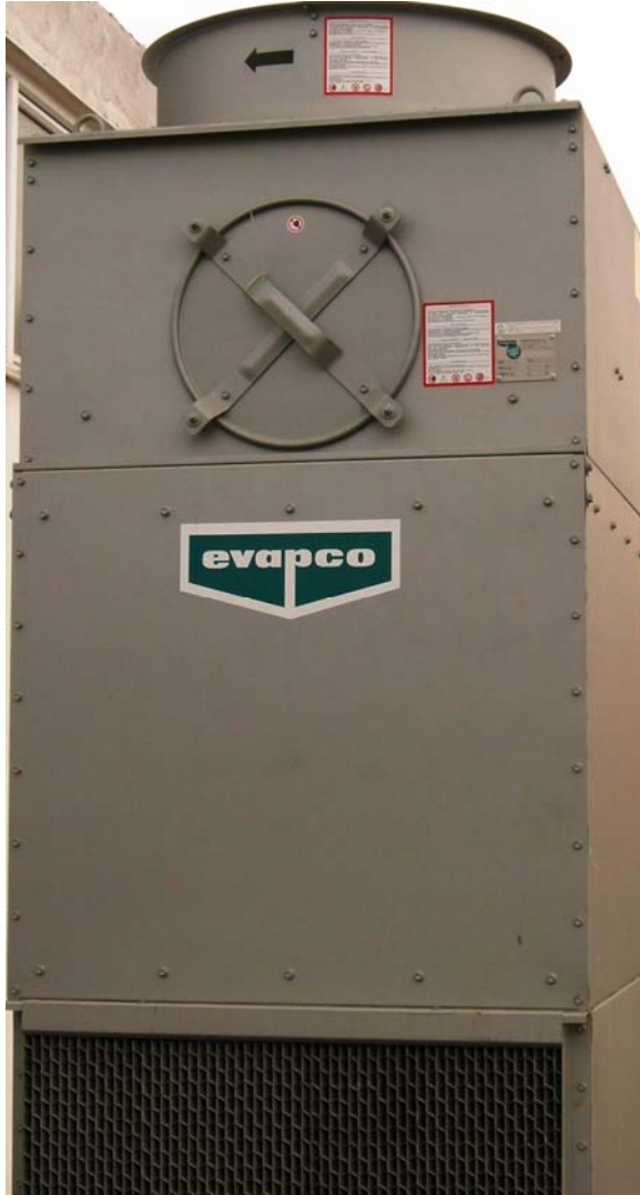
Şekil 6.5 Soğutma kulesi, TRANSKLİMA EVAPCO ICT 4-84. Soğutma kapasitesi: 210,7 kW. Giriş çıkış sıcaklığı: 35-29,4 °C .
