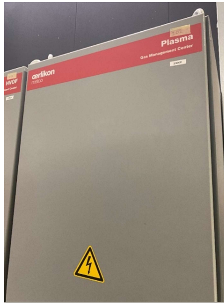
Şekil 3.6: Plazma Püskürtme Sistemi Gaz Yönetim Merkezi.
