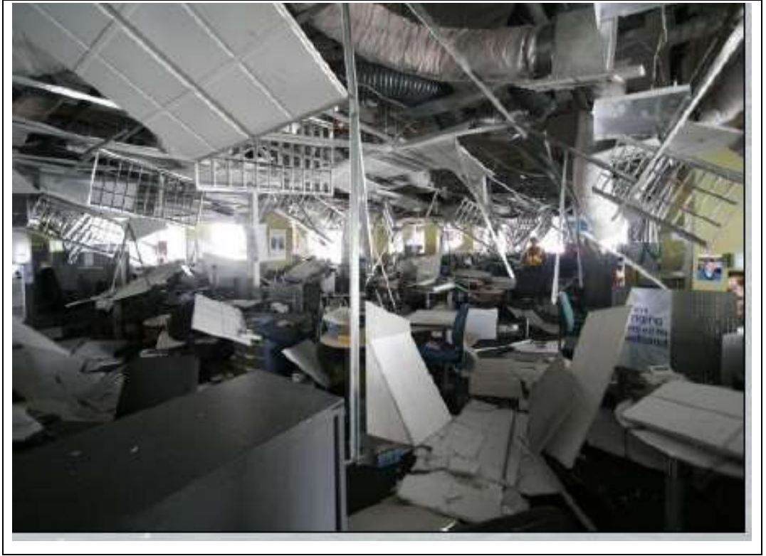
Şekil 1.2. Deprem sonrası operasyonu önleyecek hale gelmiş fabrika binası.
