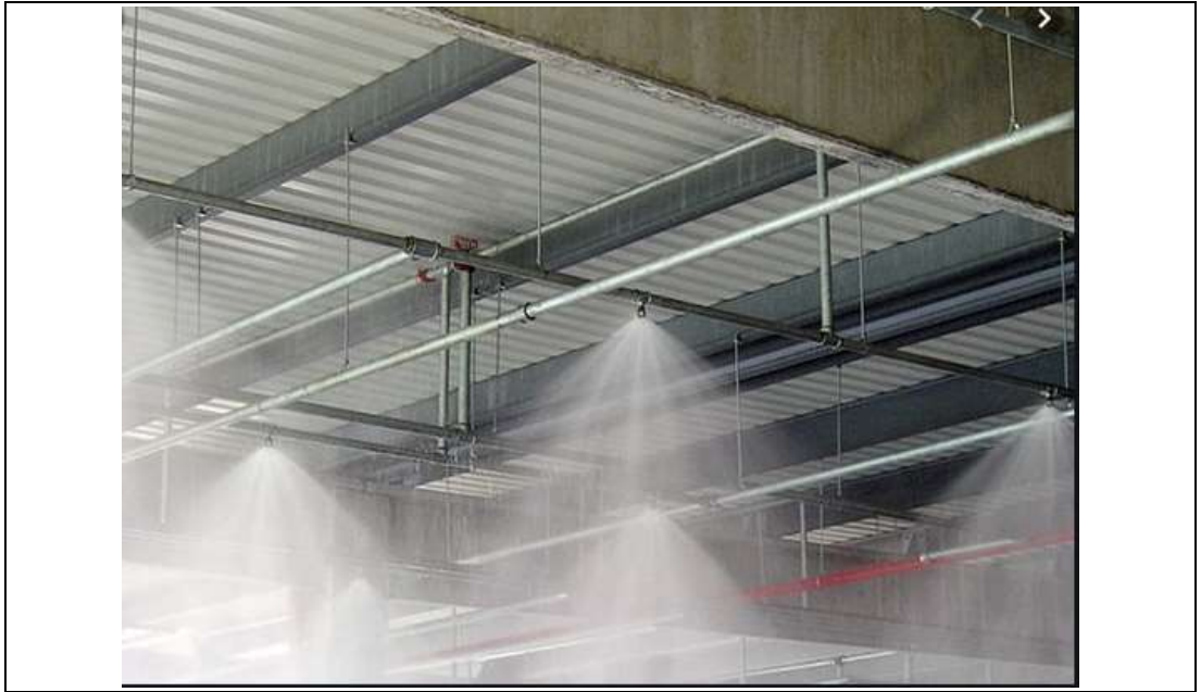
Şekil 2.11: Yangın söndürme sistem boruları.
