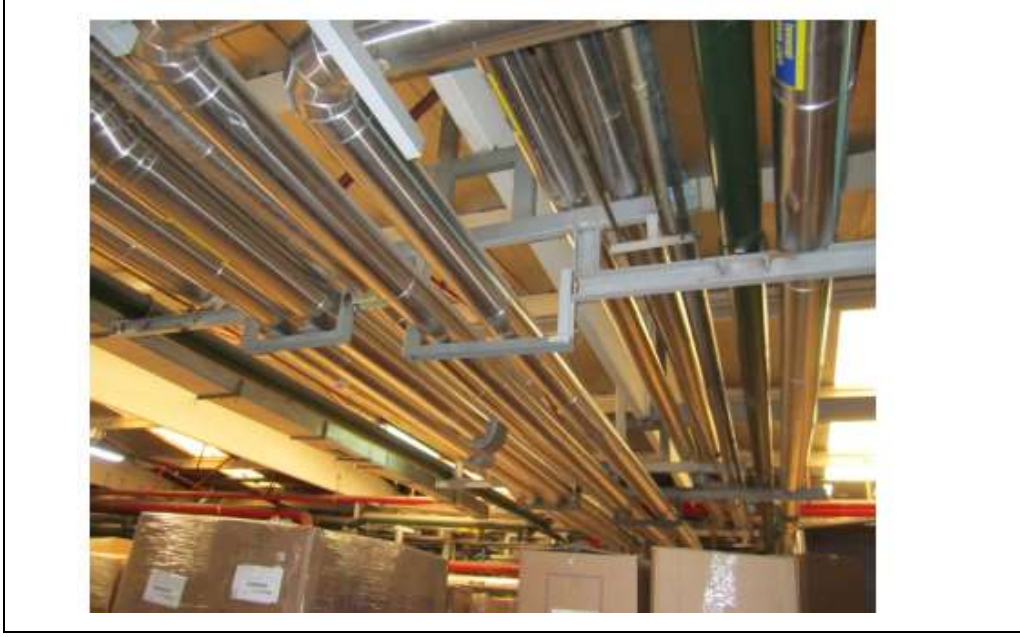
Şekil 2.7: Askıya alınmış boru ve kanallar.
