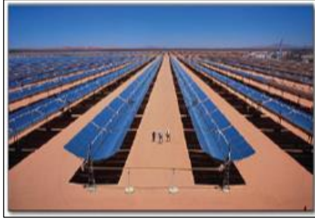
Şekil 1. 10: Parabolik aynalar yardımıyla enerji üreten termal güneş enerjisi santrali.
