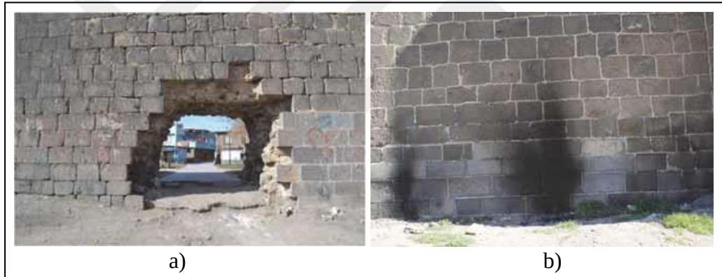
Şekil 3.10: a) Taşların sökülmesiyle oluşan geçit, b) Ateş yakılmasından dolayı oluşan kirlenmeler.
