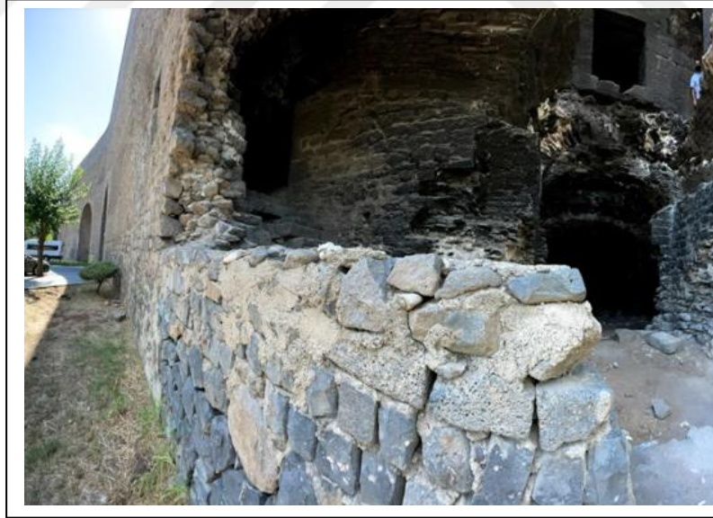
Şekil 3.6: Burçların giriş kapılarında oluşan yıkılmalar.
