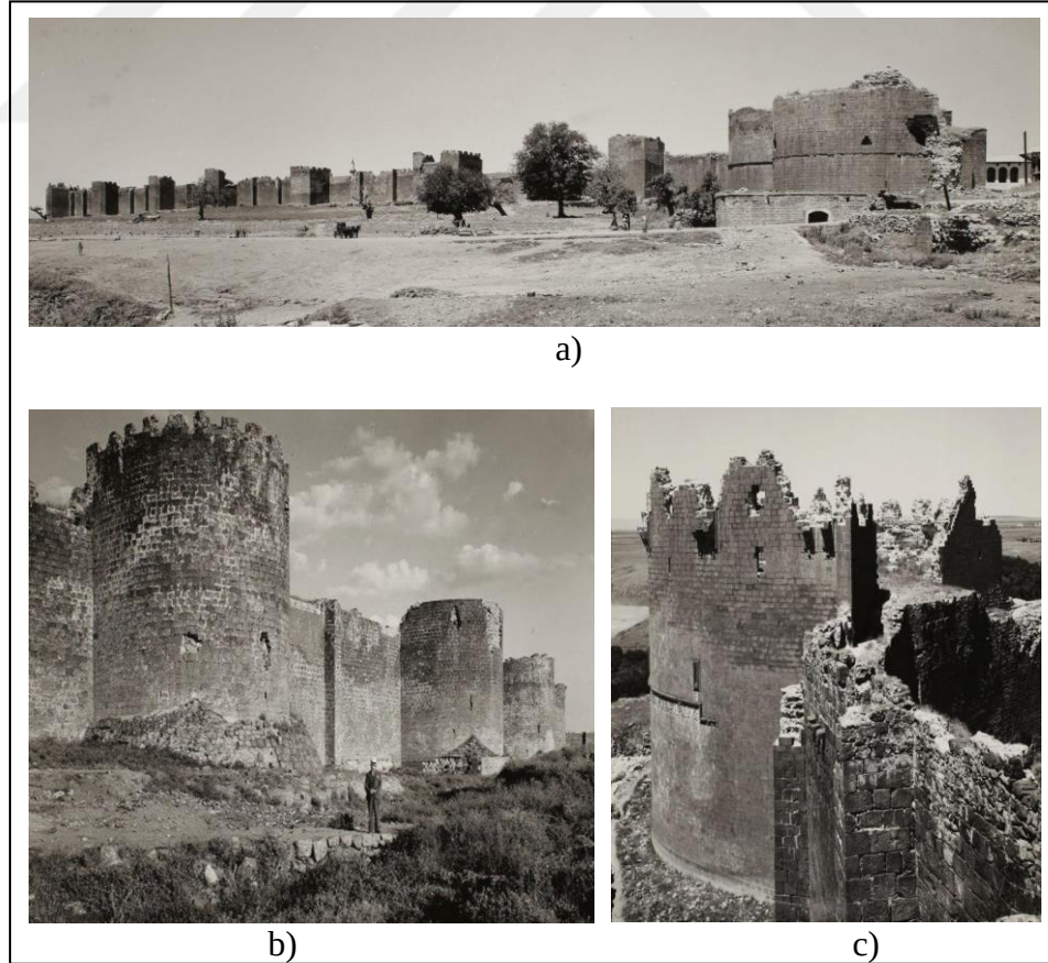
Şekil 3.3: a) 1930'larda Diyarbakır surları genel görünümü, b) 1930'larda Diyarbakır surlarına ait burçlar, c) 1930'larda Diyarbakır surlarında meydana gelen hasarlar.
