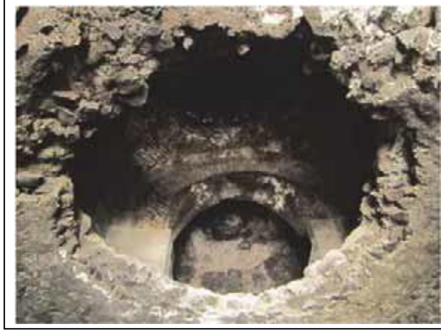
Şekil 3.7: Zamanla yıkılan döşemeler.
