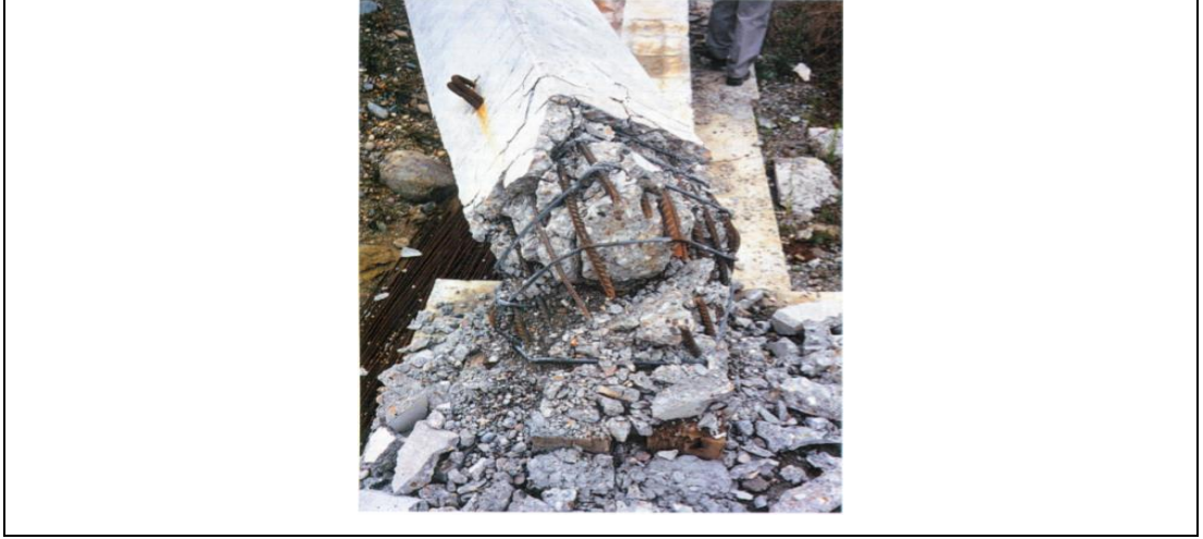
Şekil 4.16: A grubu yapı kolon hasarı.
