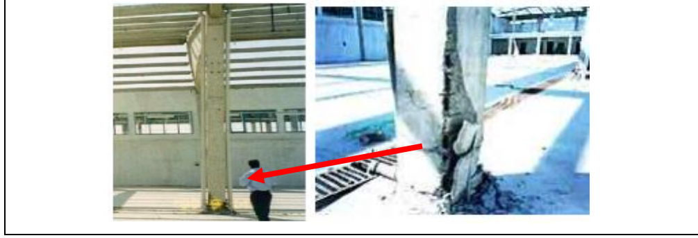
Şekil 2.10: Aşırı deplasman ve kolon hasarı görseli.
