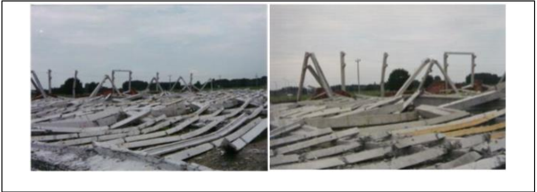
Şekil 4.17: A grubu yapı deprem sonrası görseli.
