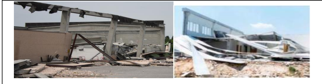
Şekil 2.11: Aşırı deplasman duvar hasarı görselleri.
