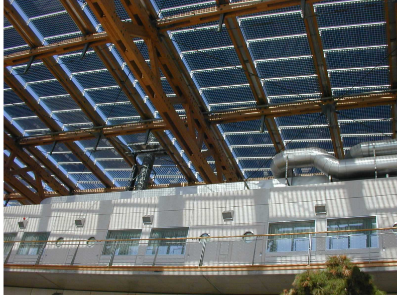
Resim 4. Çatı Örtüsüne Entegre Edilen PV Modüller [37].
