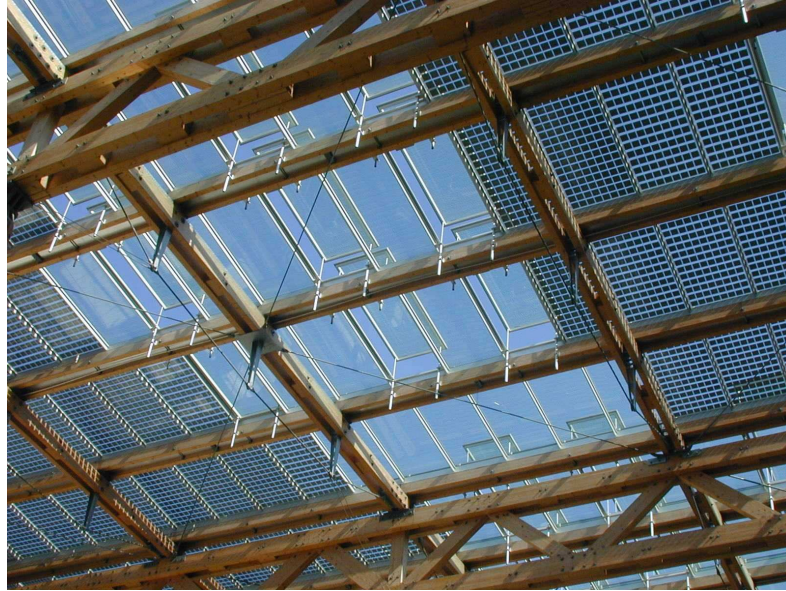
Resim 3. Çatı Örtüsüne Entegre Edilen PV Modüller [37].
