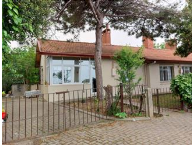
Şekil 4.15: Lojmanlarda Yapılmış Plansız Eklemeler.
