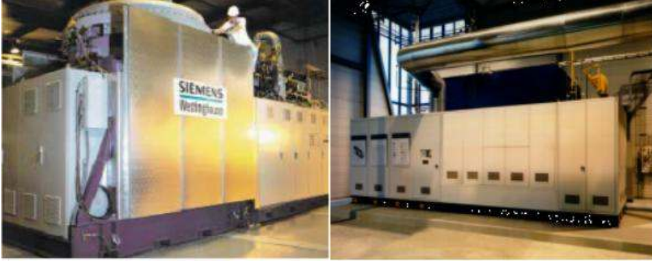
Şekil 1.1. Siemens-Westinghouse Yakıt Hücresi Sistemi [8]
