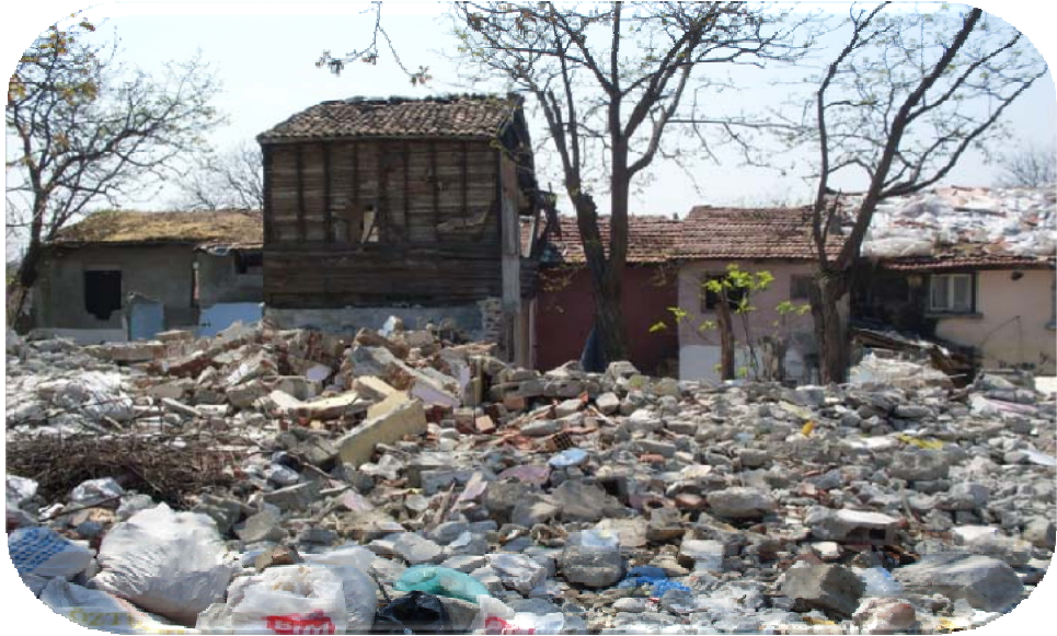
Şekil 3.4. Küçük Çeşme sokak üzerinde yıkılan yapıların atıklarından bir görüntü
