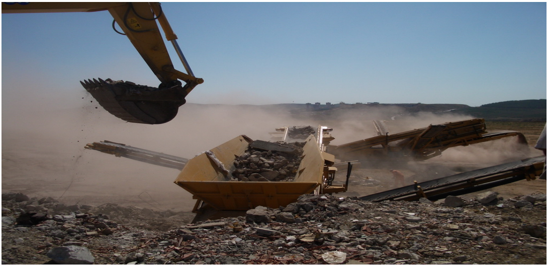
Şekil 2.7. Tuzla yapısal atık geri kazanım tesisinde bulunan moloz atıklarını kırıcı ekipman
