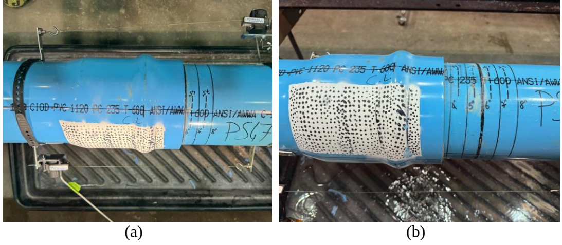
Şekil 5.38: a) Testten önce PS47 birleşimi ve b) birleşim hasarı.
