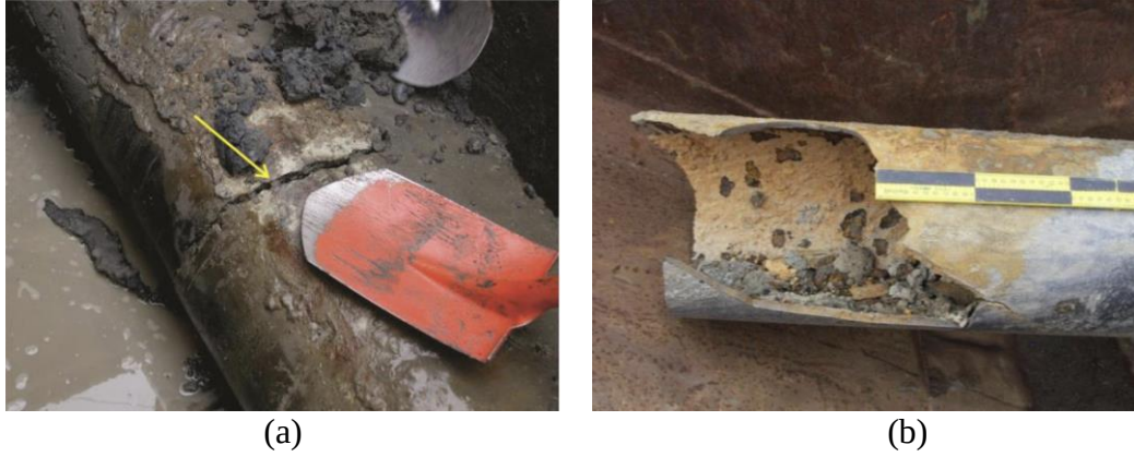
Şekil 1.1: Christchurch depreminin neden olduğu a) AC tipi boruda çevresel hasar ve b) Kırık CI tipi boru [Cubrinovski vd., 2014].
