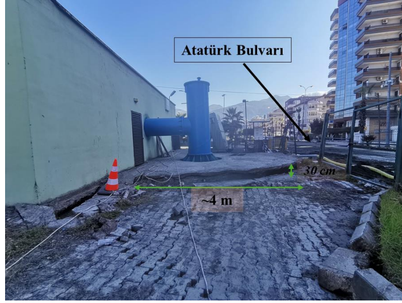
Şekil 3.16: İskenderun 1 nolu yağmur suyu yükseltme istasyonu.
