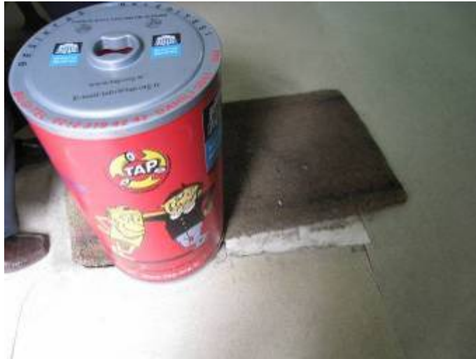
Şekil 3.90 : Çöken döşemenin çöp kovası ile kapatılması
