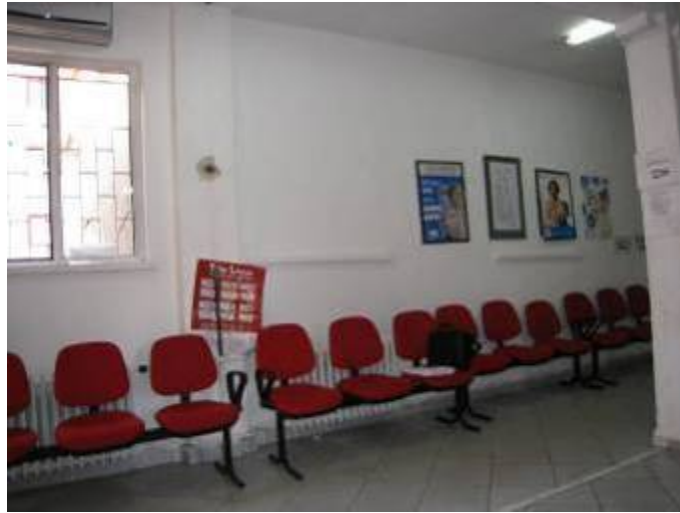
Şekil 3.46 : Plastik–kumaş oturma üniteleri, duvardaki kapatılmamış delik
