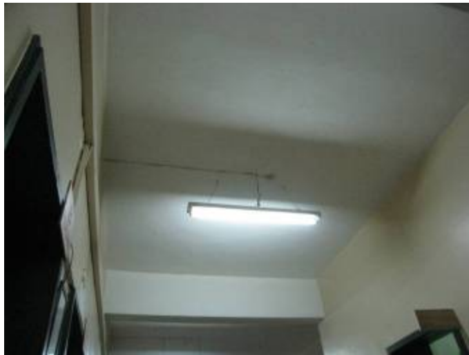
Şekil 3.59 : Tavandaki aydınlatma elemanı
