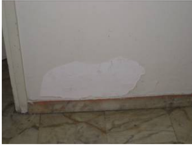
Şekil 3.81 : Duvardaki boya kabarmaları
