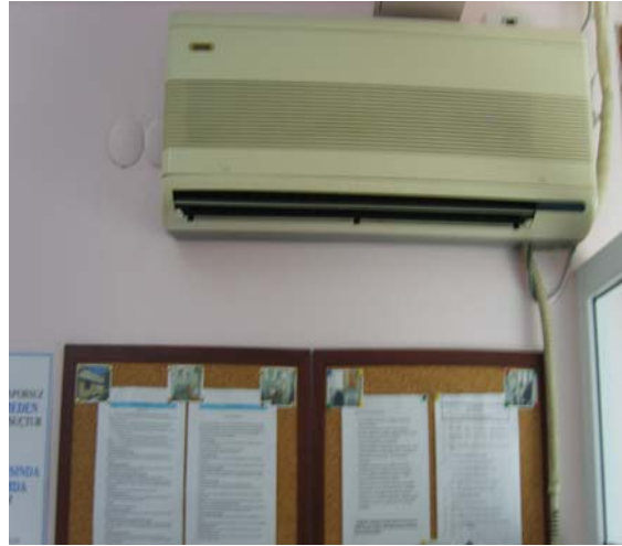
Şekil 3.34 : Bekleme alanındaki duvar tipi klima ünitesi
