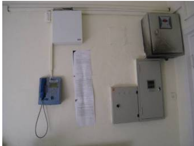
Şekil 3.68 : Giriş hol duvarındaki elektrik panoları ve telefon
