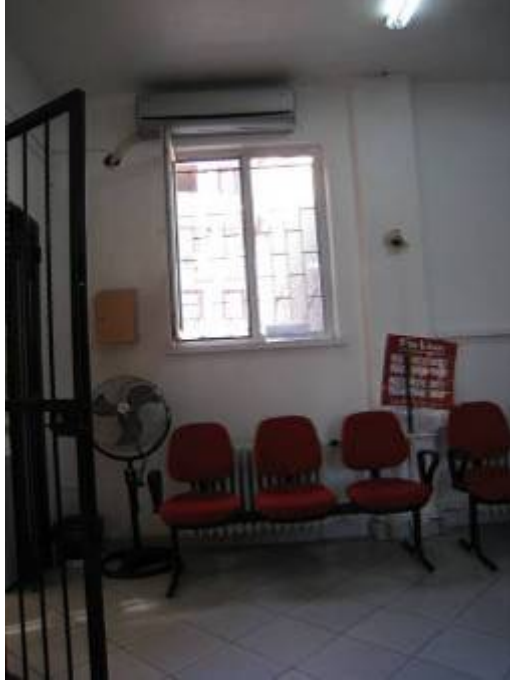
Şekil 3.47 : Petek radyatör, çalışmayan klima ünitesi ve vantilatör
