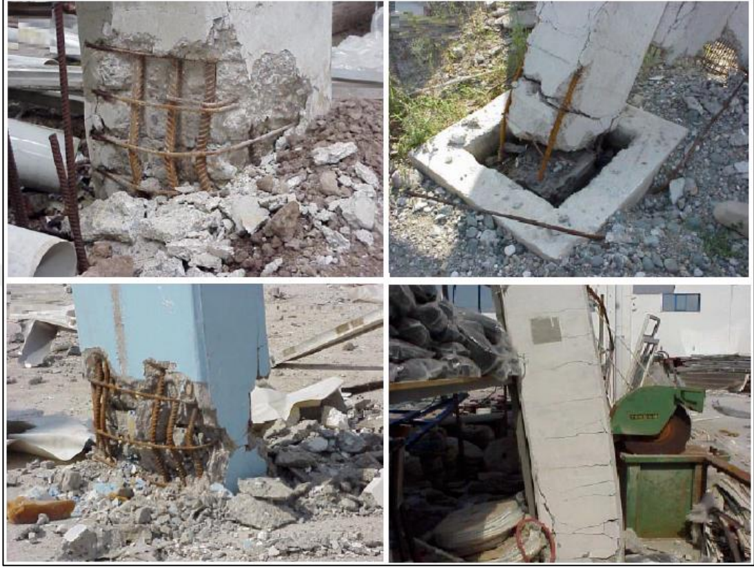
Şekil 2.7: Deprem sonrası kolonların tabanında meydana gelen plastik mafsall örnekleri.
