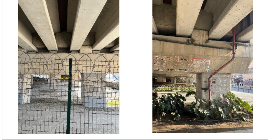
Şekil 5.46: Meydanın köprü altında görsel kirlilik içeren unsurlar.
