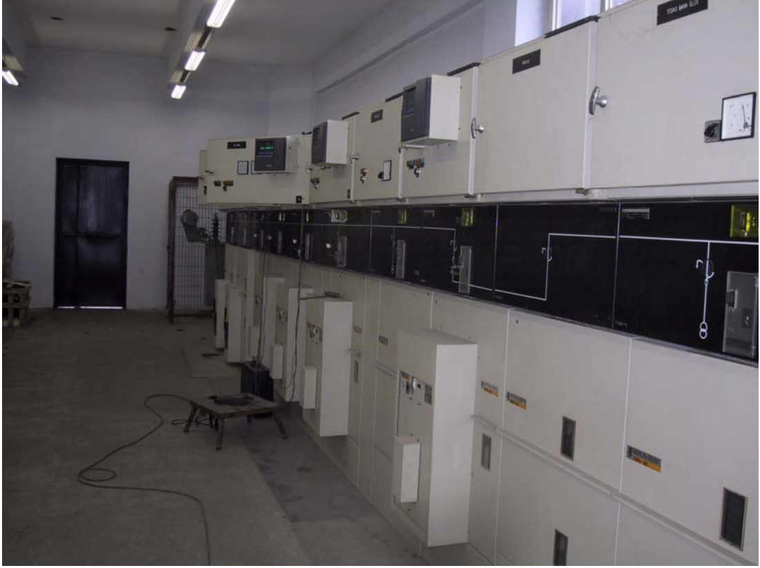
Şekil 3.3. Sarkuysan A.Ş. Şalt Tesisi
