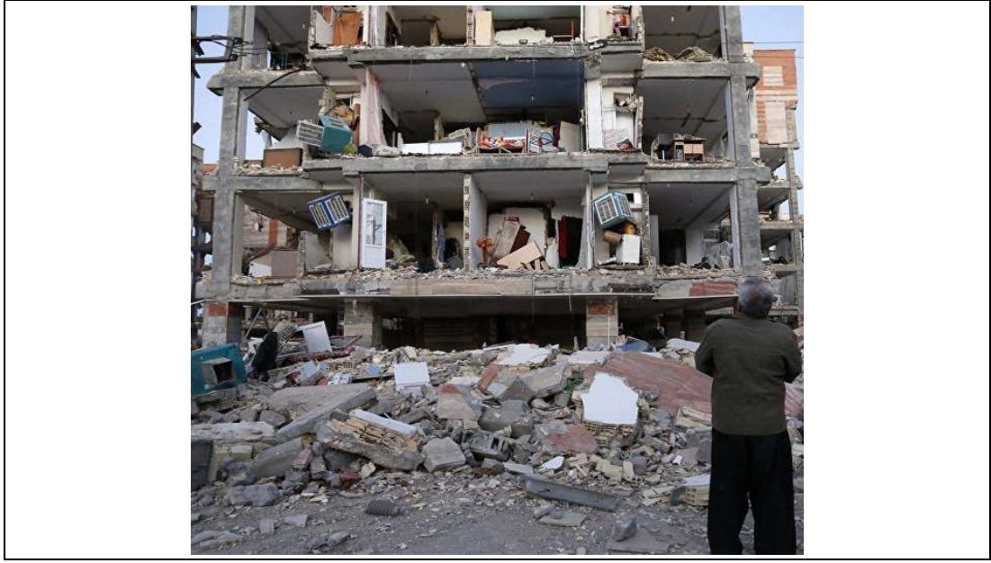
Şekil 2.15: Betonarme çerçeveli yapının dolgu duvarlarının düzlem dışı hareketi sonucu göçmesi.
