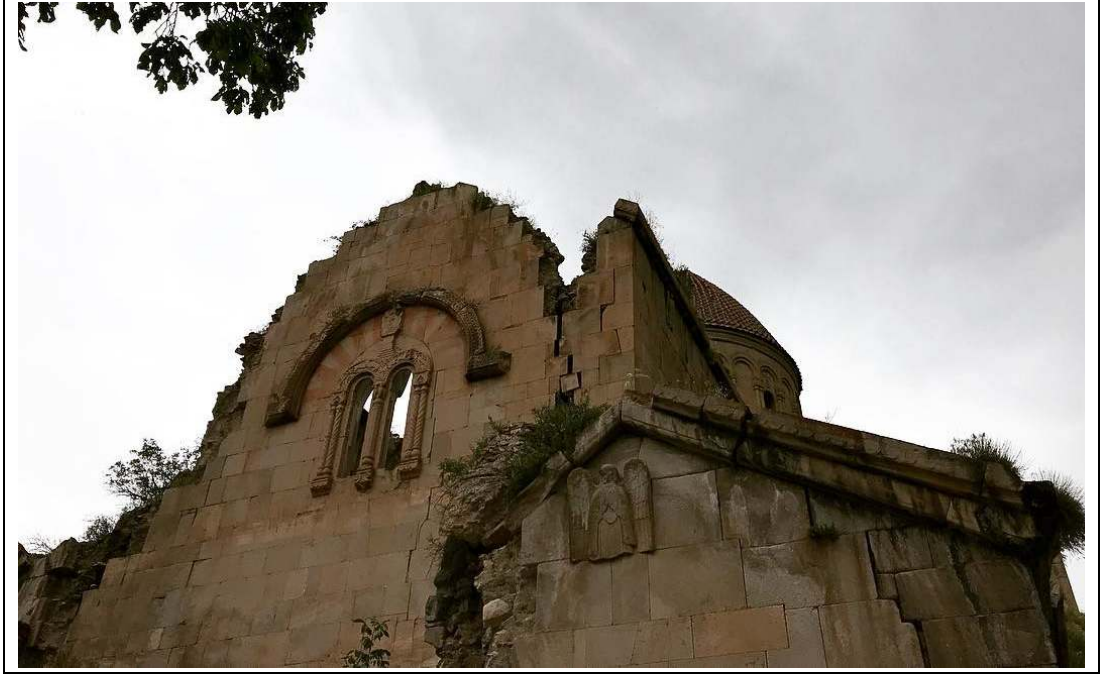
Şekil 5.12: Batı cephesinin düzlem dışı davranış yapan duvarı.
