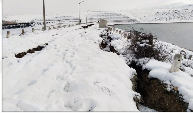
Şekil 6. 57: Sultansuyu Barajı memba şev başlangıcı memba yönlü yanal hareket 1 m.
