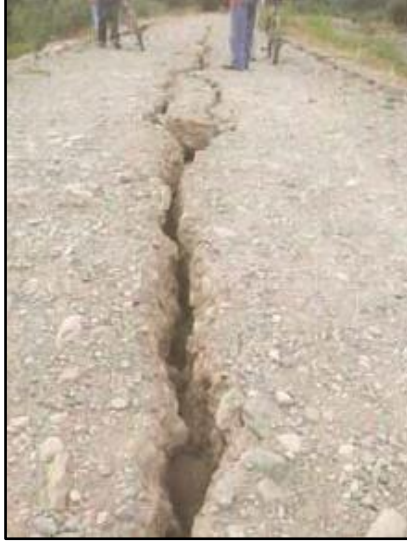
Şekil 4. 4: Coihueco Barajı kret boyuna çatlakları (Mw 8.8).
