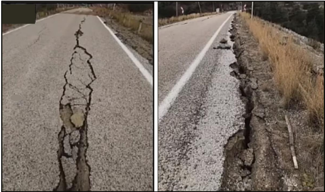
Şekil 6. 80: Kret boyunca oluşan aksa paralel çatlaklar.
