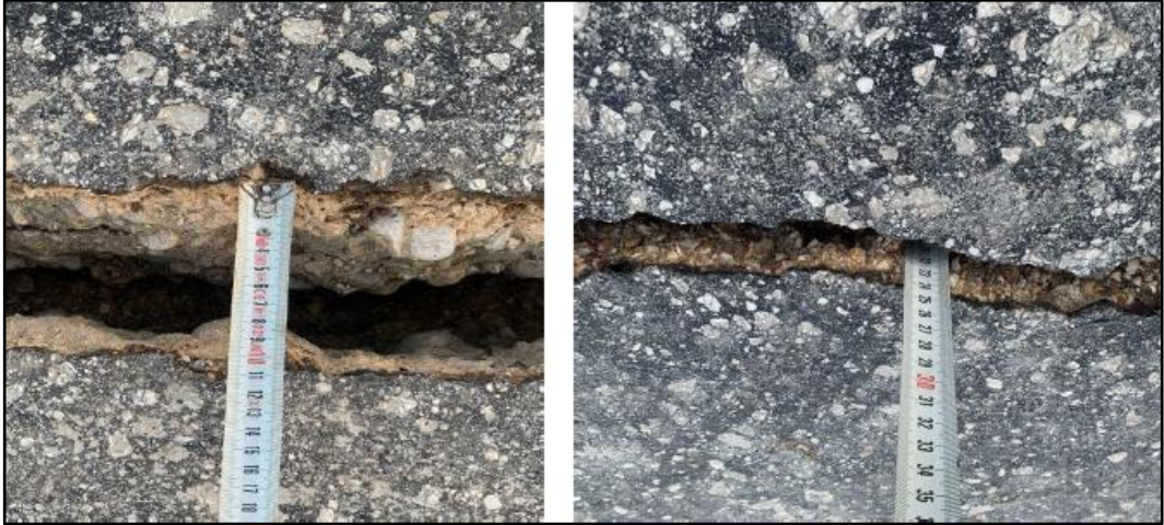
Şekil 6. 90: Kret üzerindeki çatlaklar.
