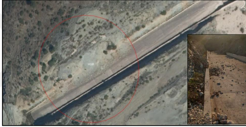
Şekil 6. 33: Dolusavak boşaltım kanalı üzerinde oluşan heyelanlar.
