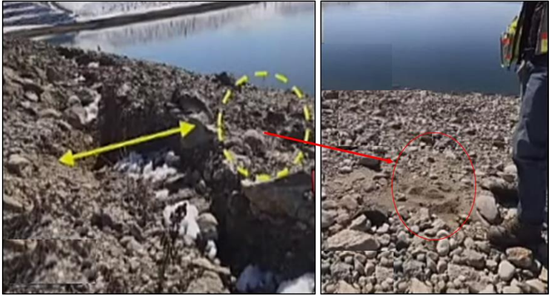
Şekil 6. 60: Memba şevinde kalıcı yanıl hareket ve sıvılaşma belirtileri.
