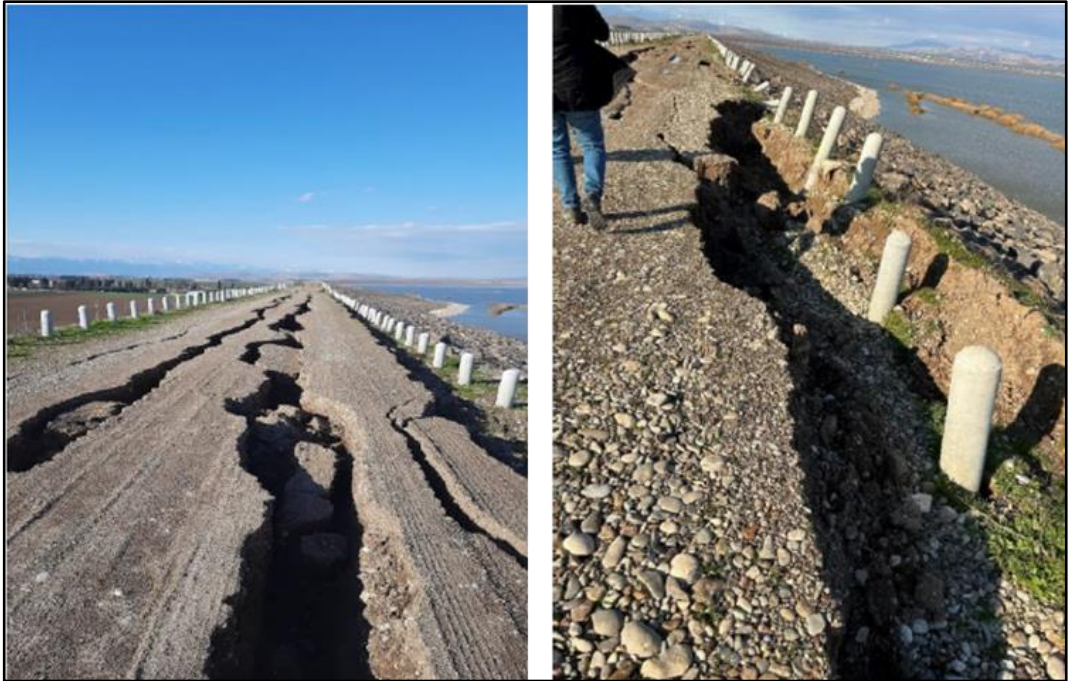
Şekil 6. 45: Baraj kreti Km: 6+200 – 8+120 arası büyük çatlaklar ve memba şev başlangıcında memba yönlü kalıcı hareket ve oturma.
