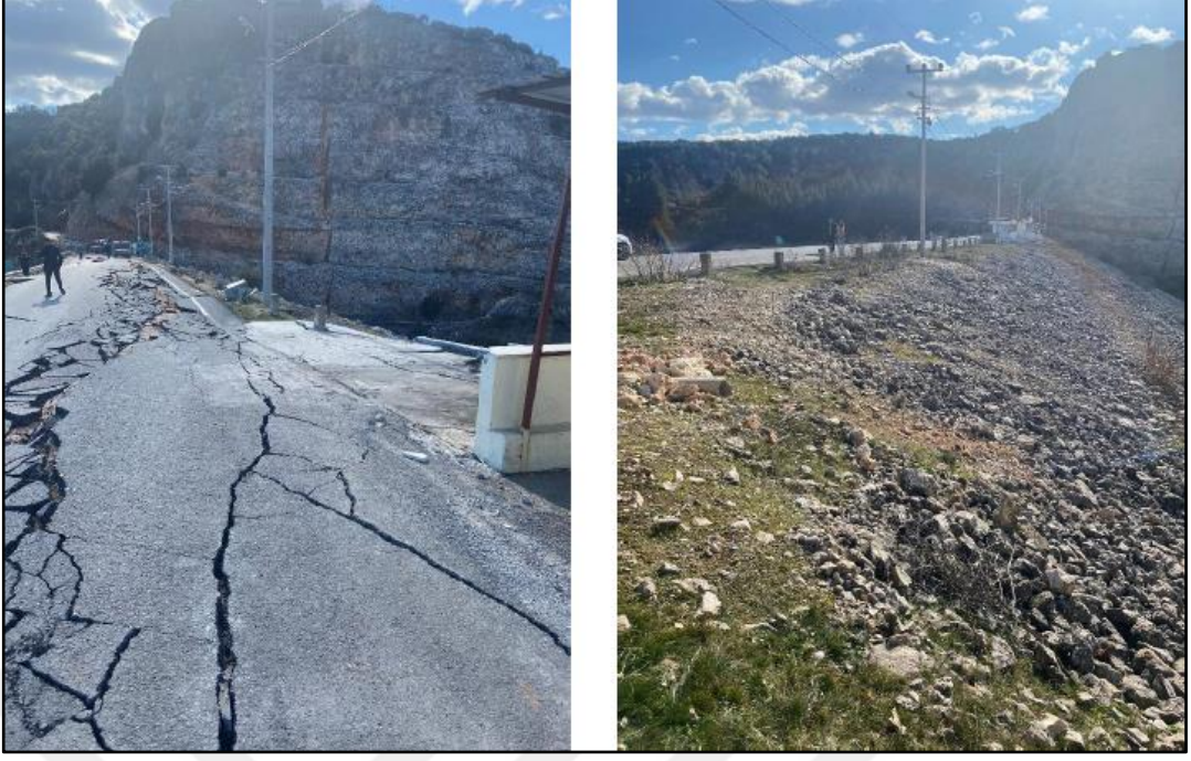
Şekil 6. 106: Kret boyunca oluşan çatlaklar ve mansap şevi görünümü.
