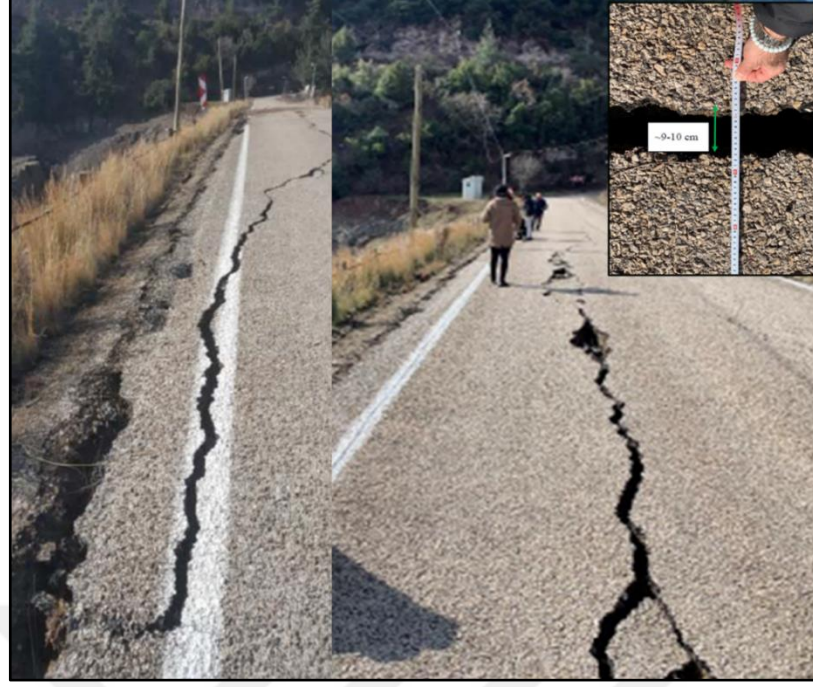
Şekil 6. 81: Kret boyunca oluşan aksa paralel çatlaklar G:10 cm D: 150 cm.
