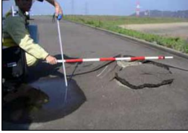
Şekil 4. 16: Shin-Yamamoto Barajı kret oturması Niigata Depremi (Mw 6.6) 2004.
