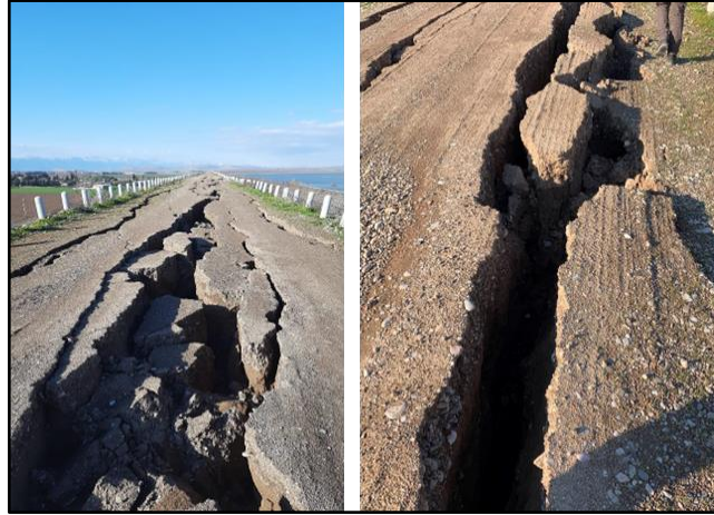
Şekil 6. 46: Baraj kreti Km: 6+200 – 8+120 arası büyük çatlaklar ve memba şev başlangıcında memba yönlü kalıcı hareket ve oturma.
