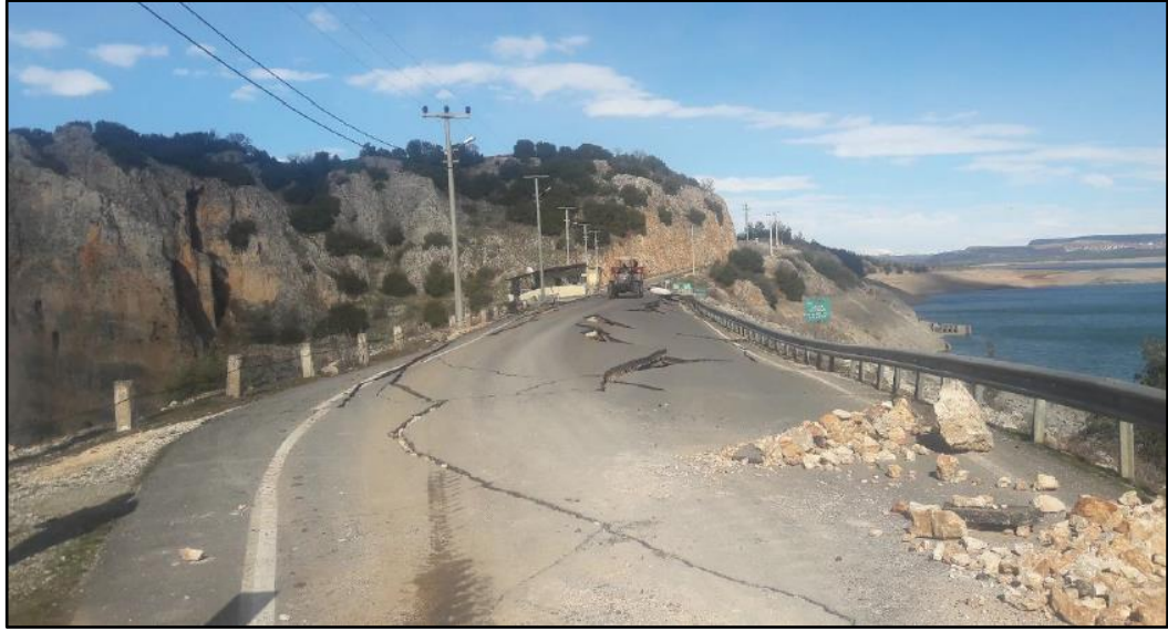
Şekil 6. 101: Kret üzerindeki çatlaklar ve memba yönlü oturma.
