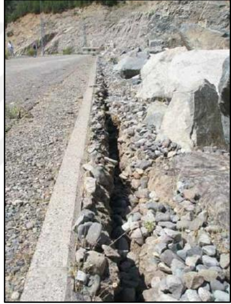
Şekil 4. 3: Meloda Barajı kret memba şev birleşimindeki boyuna çatlaklar Maule Depremi, Şili, Mw: 8.8.
