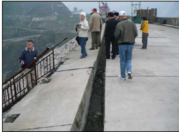
Şekil 4. 18: ÖBKD Zipingpu Barajı kret mansap birleşiminde oturma.
