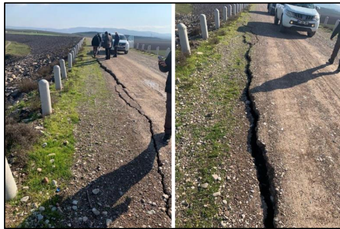
Şekil 6. 48: Baraj kreti Km: 8+120 - 9+200 arasındaki çatlaklardan görünüm.
