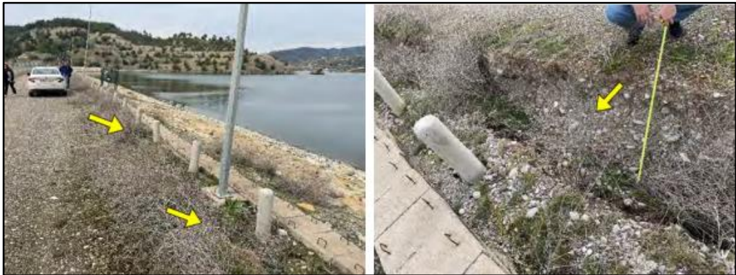
Şekil 6. 127: Kılavuzlu Barajı kretinde oluşan oturma ve memba yönlü yanal hareket.
