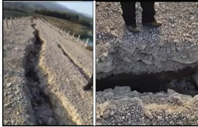
Şekil 6. 30: Kret boyunca aksa paralel çatlaklar.
