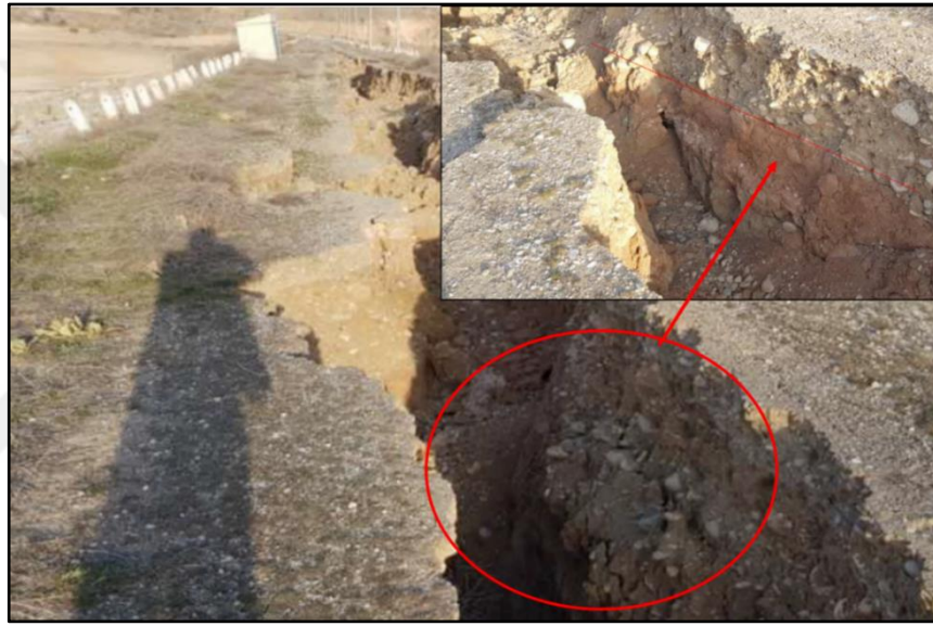
Şekil 6. 62: Krette kil çekirdeğe ulaşan derin çatlaklar.
