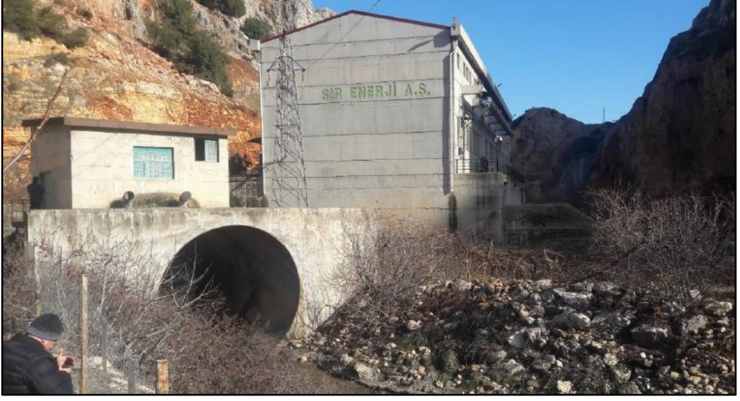
Şekil 6. 110: Sağ sahilde yer alan dipsavak çıkışı ve santral binası.
