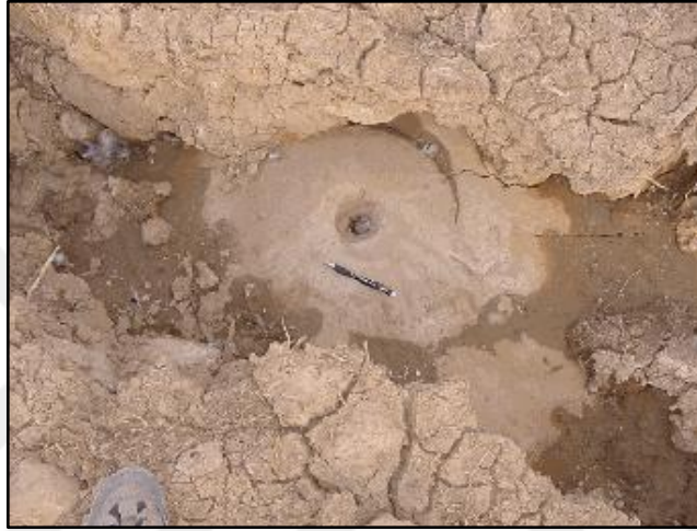
Şekil 4. 10: Chang Barajı memba topuğunda gözlemlenen kum kaynamaları, 26 Ocak 2001 (Mw 7.7).
