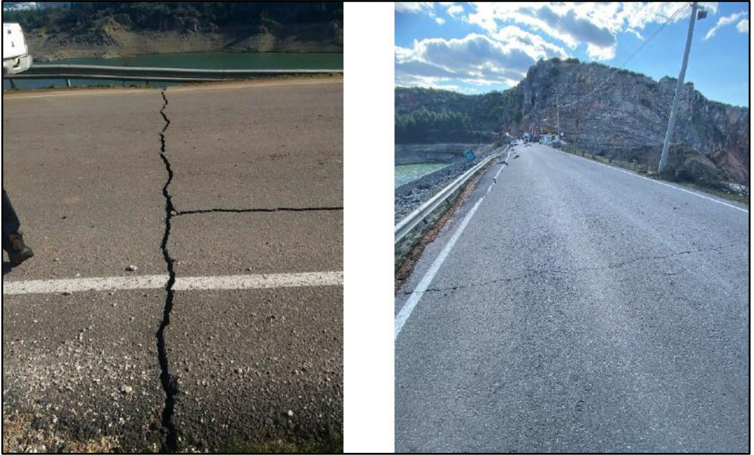
Şekil 6. 105: Krette oluşan enine çatlaklar.
