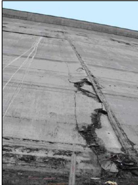
Şekil 4. 1: Zipingpu Barajı önyüz betonu maksimum kesitteki çatlaklar.
