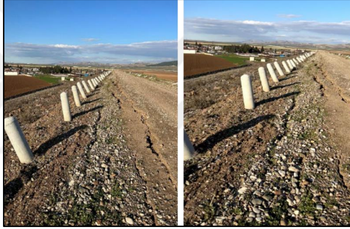
Şekil 6. 42: Baraj Kreti Km: 0+900 – 2+000 arası hasarları.
