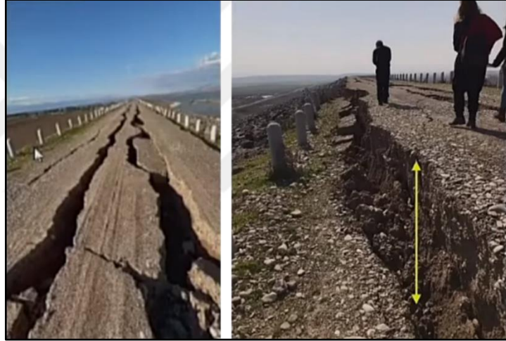
Şekil 6. 50: Baraj kreti Km: 6+200 – 8+120 arası büyük çatlaklar ve memba şev başlangıcında memba yönlü kalıcı hareket ve oturma 1,2 m.
