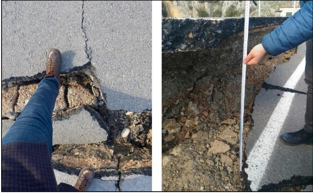
Şekil 6. 103: Kret üzerindeki çatlak G:80 cm D:100 cm
