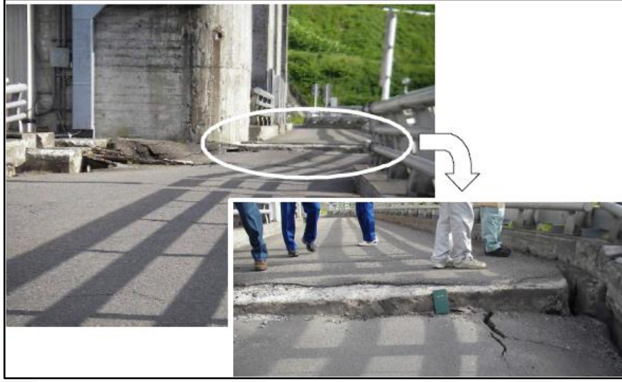
Şekil 4. 19: Minase Barajı gövde dolusavak bağlantısında farklı oturma mansap birleşiminde oturma 14 Haziran 2008 Mw 6.9 Iwate-Miyagi Nairku Depremi, Japonya.
