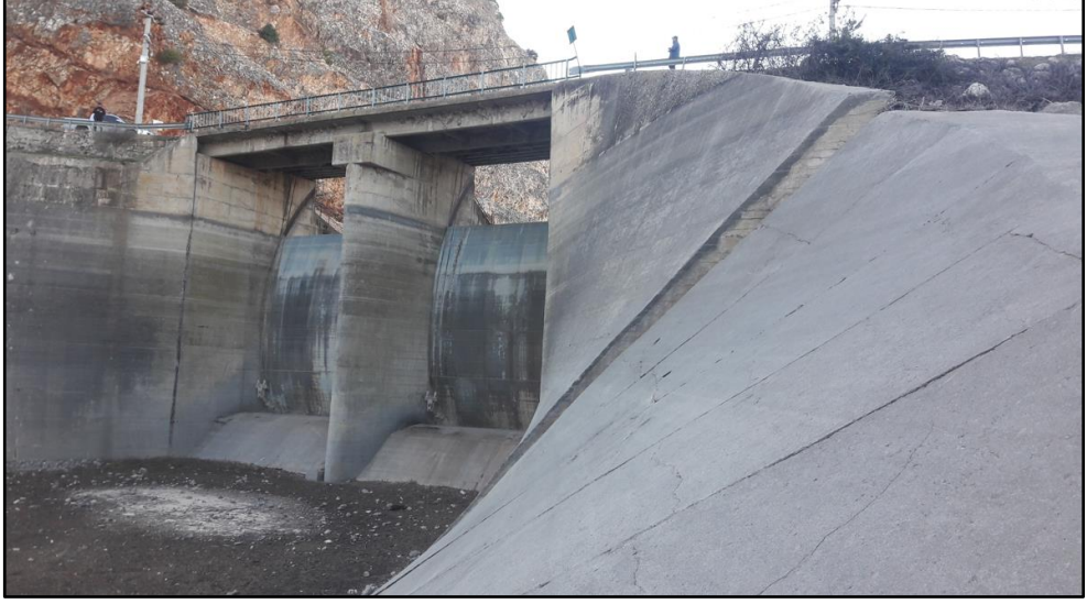
Şekil 6. 108: Dolusavak yaklaşım kanalı sağ kanat duvarındaki çatlaklar.
