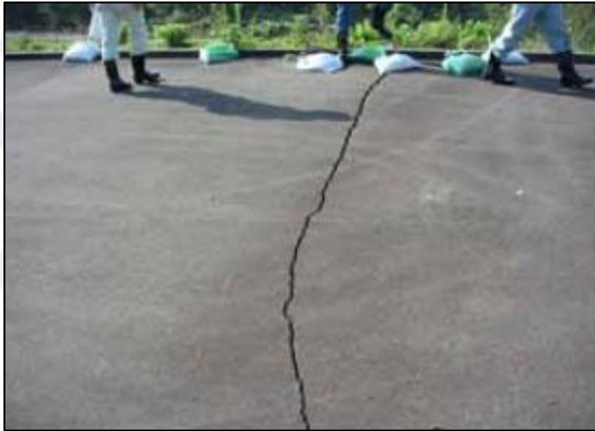
Şekil 4. 7: Shin-Yamamoto Barajı kreti asfalt kaplamada oluşan enine çatlak Niigata-ken Chuetsu Depremi (Mw 6.6) 23 Ekim 2004.
