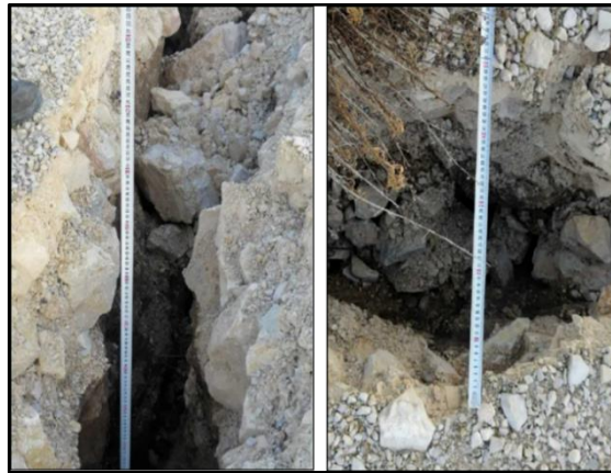
Şekil 6. 31: Krette memba yönlü oluşan çatlaklar G:1,1 m D: 2,2 m.
