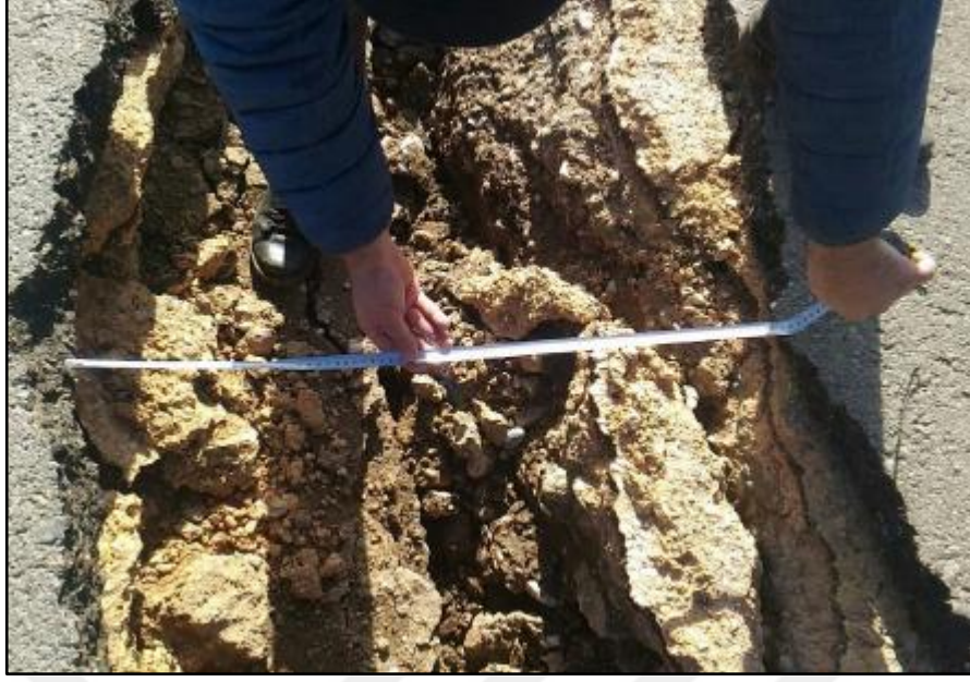
Şekil 6. 102: Kret üzerindeki çatlak G:80 cm D:100 cm.
