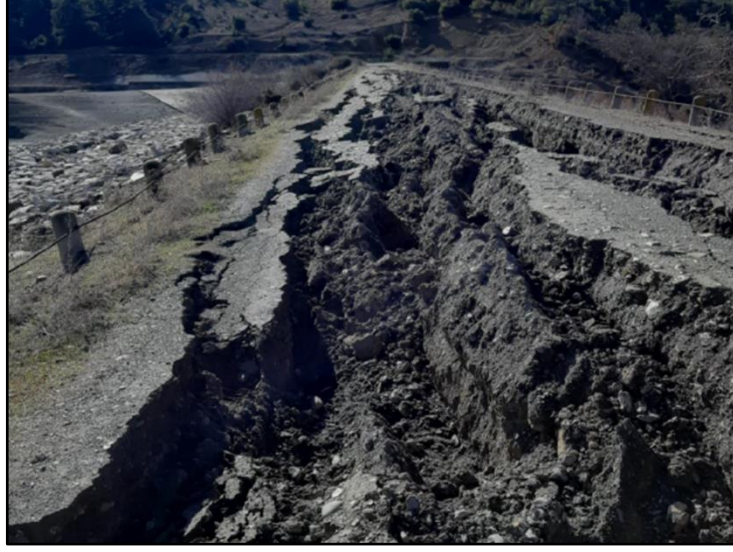
Şekil 6. 15: Krette derin çatlaklar ve memba yönlü yanal hareket D:0,8~2 m.
