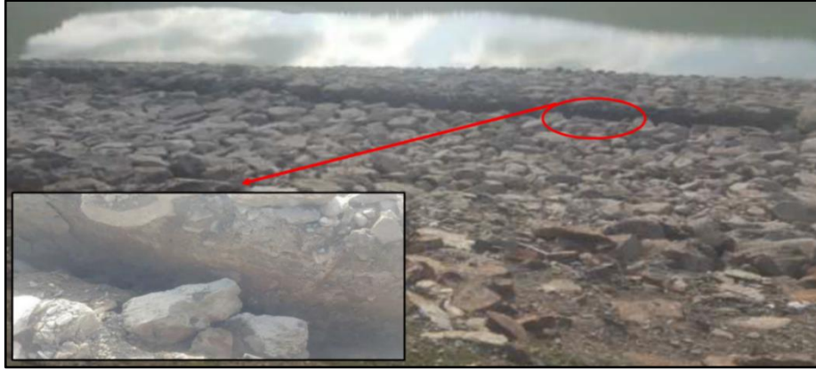
Şekil 6. 18: Memba şevinde kalıcı yanal açılma D:1,5~2 m G:1m.
