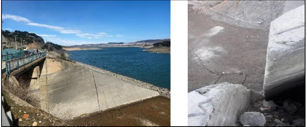
Şekil 6. 107: Dolusavak yaklaşım kanalı sağ kanat duvarındaki çatlaklar.
