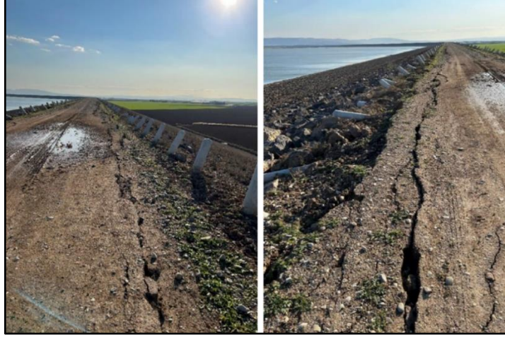
Şekil 6. 41: Baraj Kreti Km: 0+900 – 2+000 arası hasarları.
