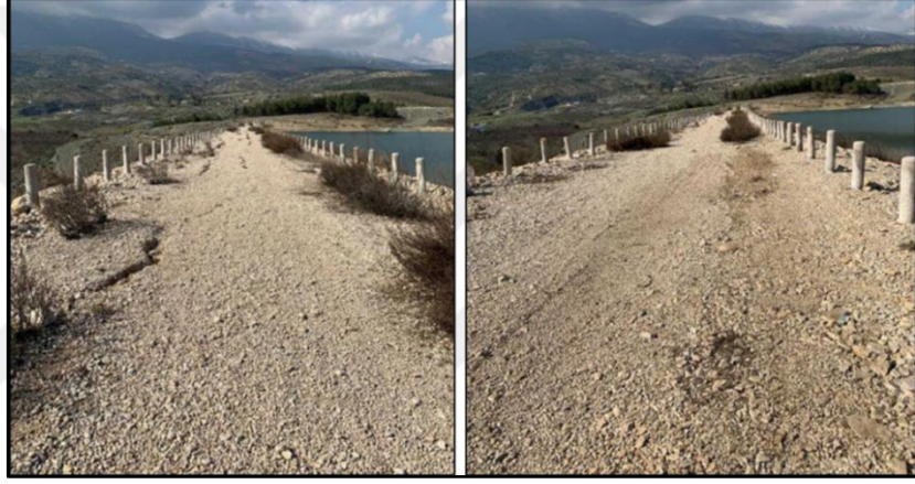
Şekil 6. 27: Sol sahilden kret görünümü ve aksa paralel çatlaklar.
