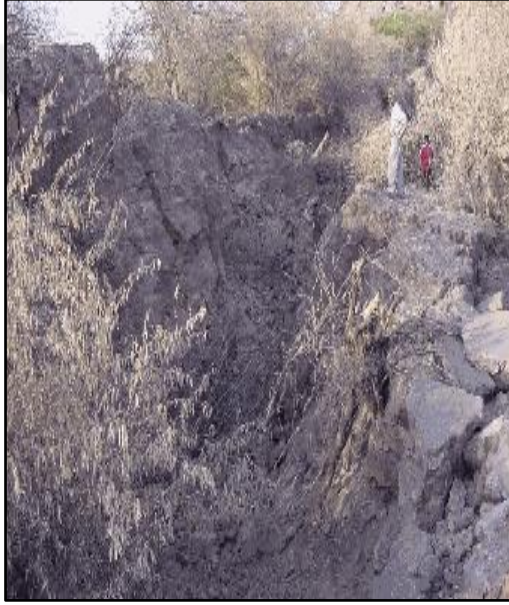
Şekil 4. 2: Chang Barajı kretinin yanında oluşan ve derinliği yaklaşık 10 metreyi bulan çatlaklar Bhuj Depremi, Mw: 7.7.
