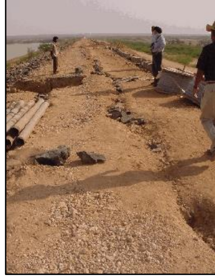
Şekil 4. 5: Tapar Barajı kret boyuna çatlakları D:3m (Mw 7.7).
