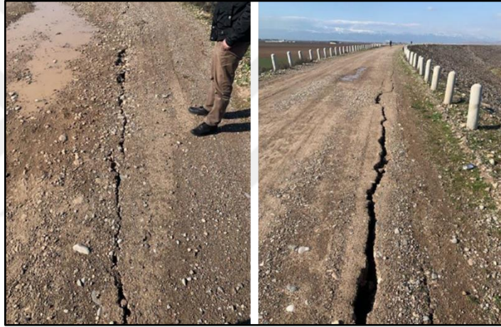
Şekil 6. 47: Baraj kreti Km:8+120 - 9+200 arasındaki çatlaklardan görünüm.
