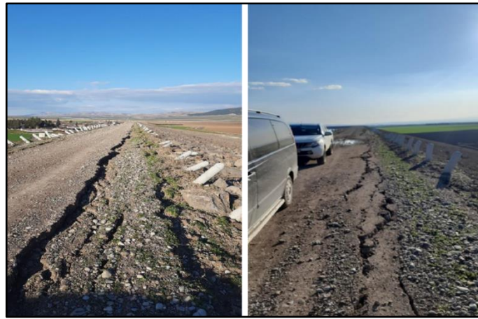
Şekil 6. 43: Baraj Kreti Km: 0+900 – 2+000 arası hasarları.
