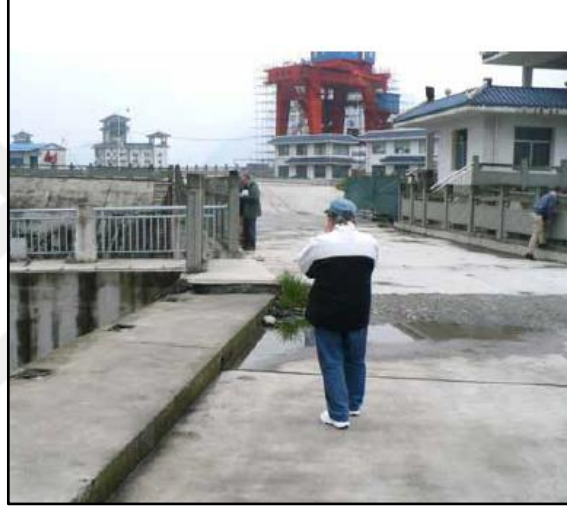
Şekil 4. 17: ÖBKD Zipingpu Barajı Dolusavak duvarı dolgu oturması.
