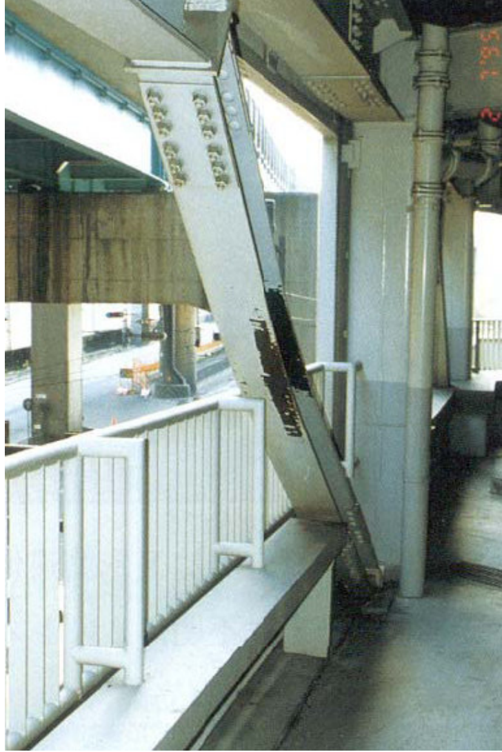
Şekil 5.2. Burkulmuş Bir Çapraz Eleman[Engelhardt, 2007]
