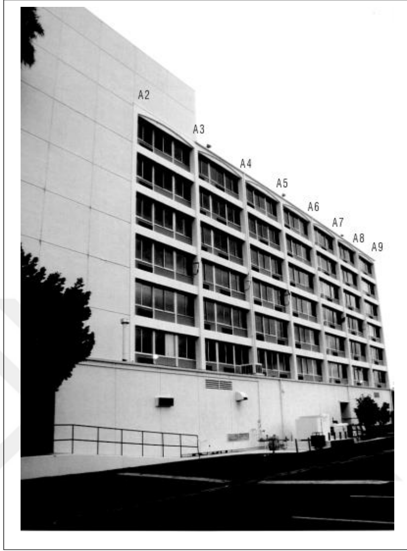
Şekil 4.7: Hasar almış bina genel görünümü.
