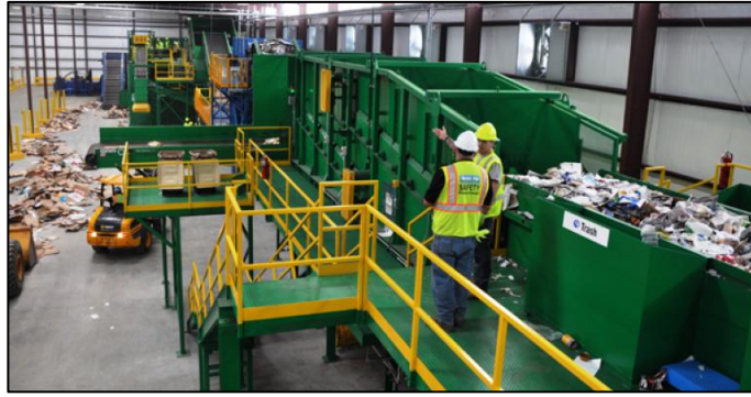
Şekil 2.8: Atık geri kazanım tesisi (MRF).
