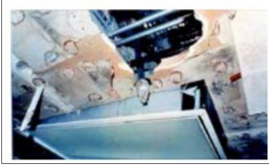
Şekil 2.4: 1994 Northridge depreminde yangın söndürme sistemi hasarı.
