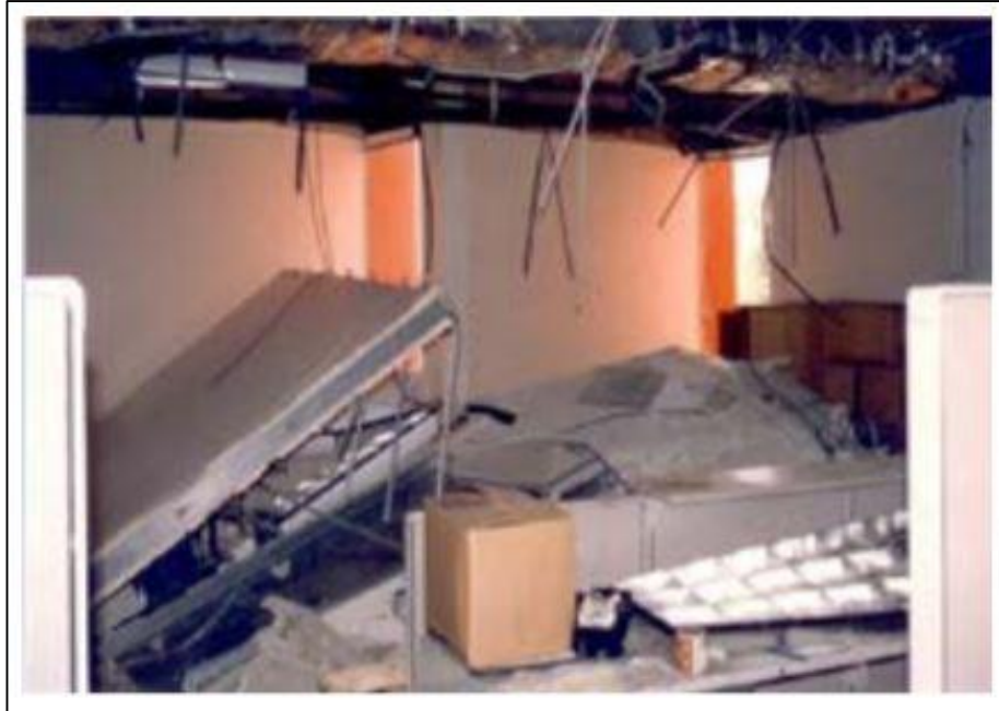
Şekil 2.3: 1994 Northridge depreminde yıkılan duvarlar ve asma tavanlar.
