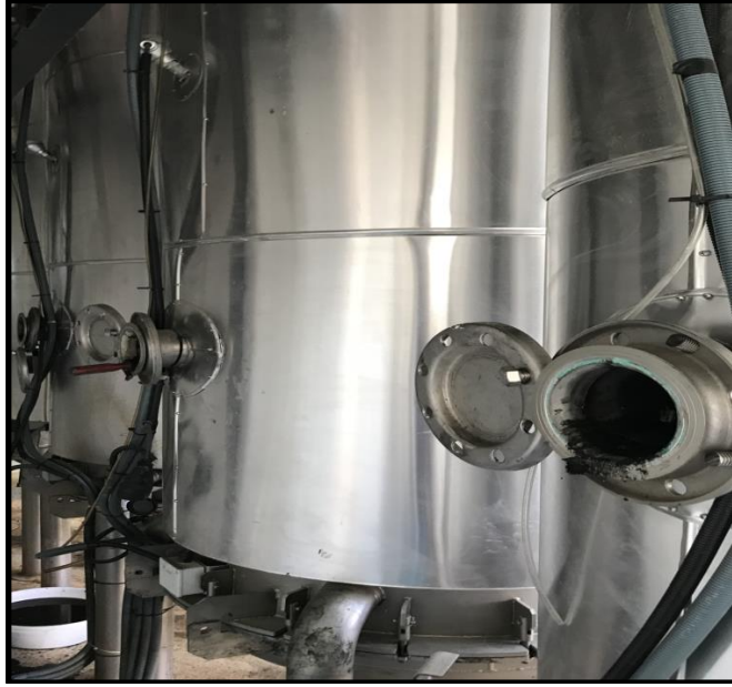
Şekil 4.13: 540 günlük işletim süresi sonrası, reaktörlerden numune alma kapaklarının açılarak numune alınması.
