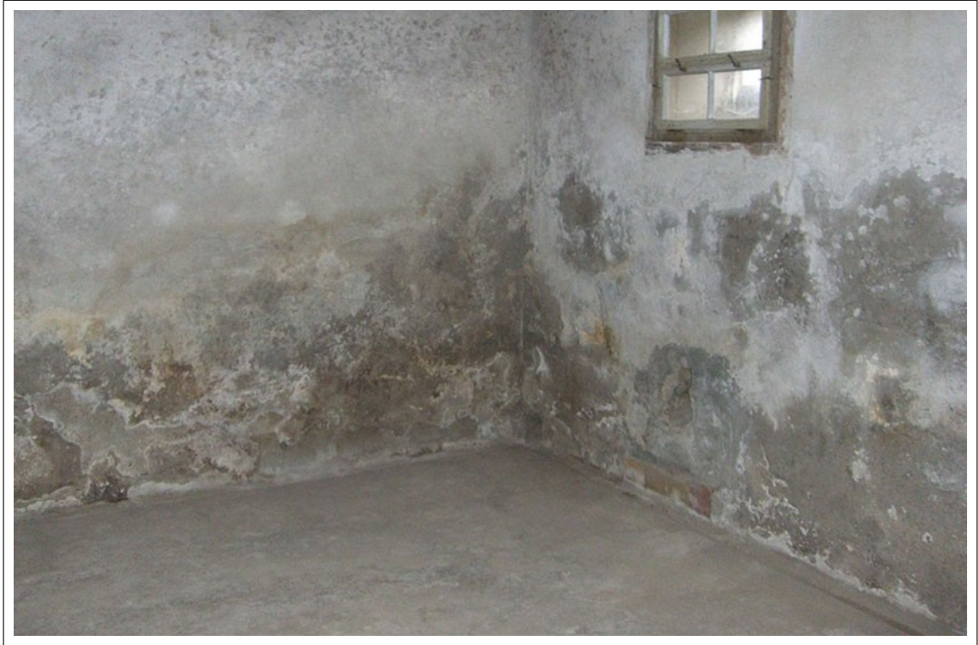
Şekil 2.10: Su yalıtımı yetersiz temel hasarı.
