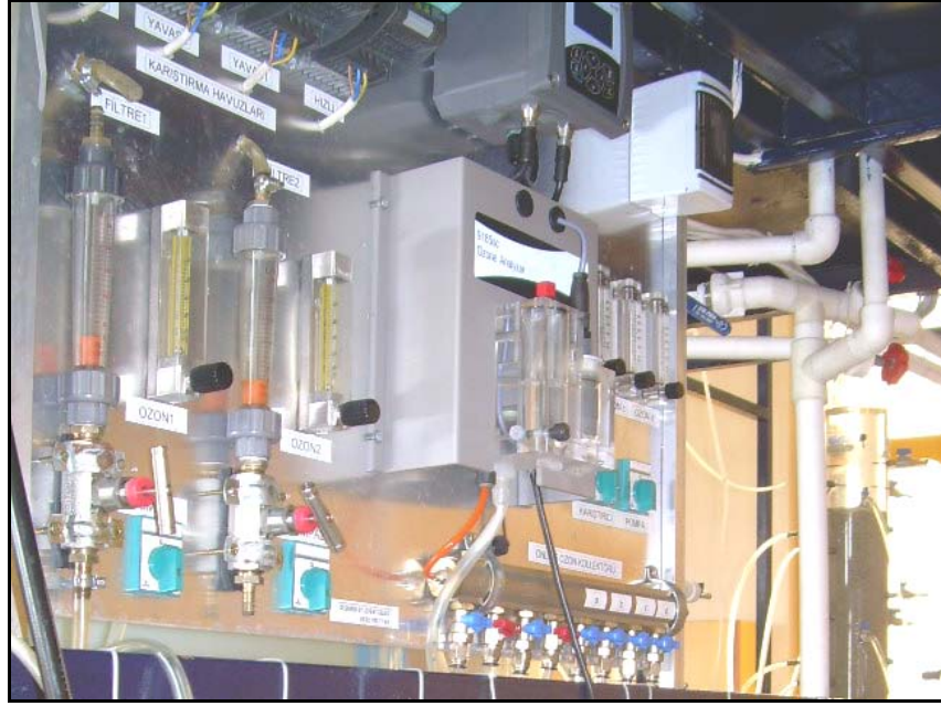
Şekil 4.4. Pilot tesis kontrol paneli
