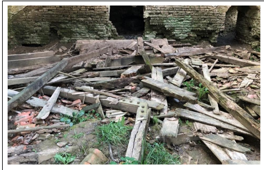
Şekil 4.11: Z-01 nolu mekân zeminindeki çöken ahşap çatı malzemeleri (2018).
