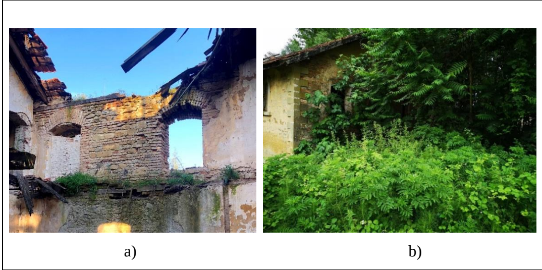
Şekil 4.55: a) Yapının döşeme kirişlerinde görülen bitkilenme, b) Binanın çevresindeki bitkilenme ve ağaç oluşumu.
