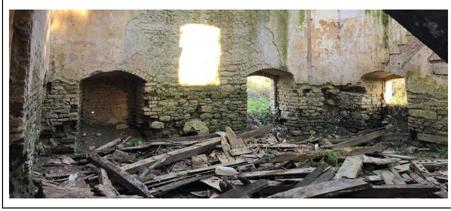
Şekil 4.38: Z-01 mekânının çöken yapı elemanlarının kapattığı zemini.
