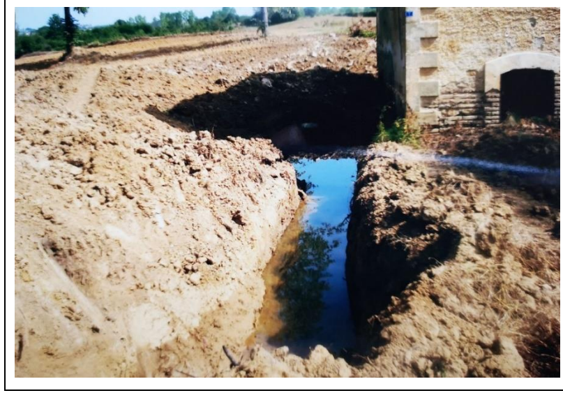
Şekil 4.52: 2009 yılında izinsiz bina çevresinde kazı yapılan alan.
