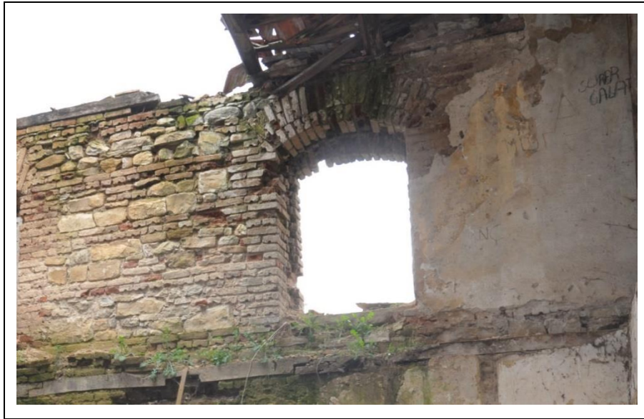
Şekil 4.32: Değirmenin doğu duvarında bulunan ahşap hatıllar.
