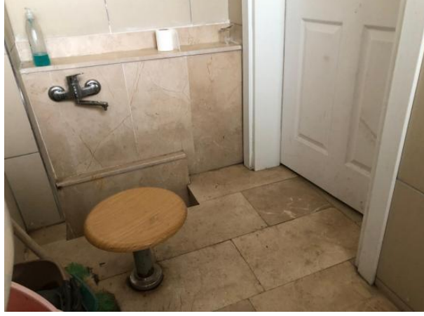
Şekil 3.59: Sağlıksız şadırvan örneği, Kubbeli Camii, Sakarya, 2024.
