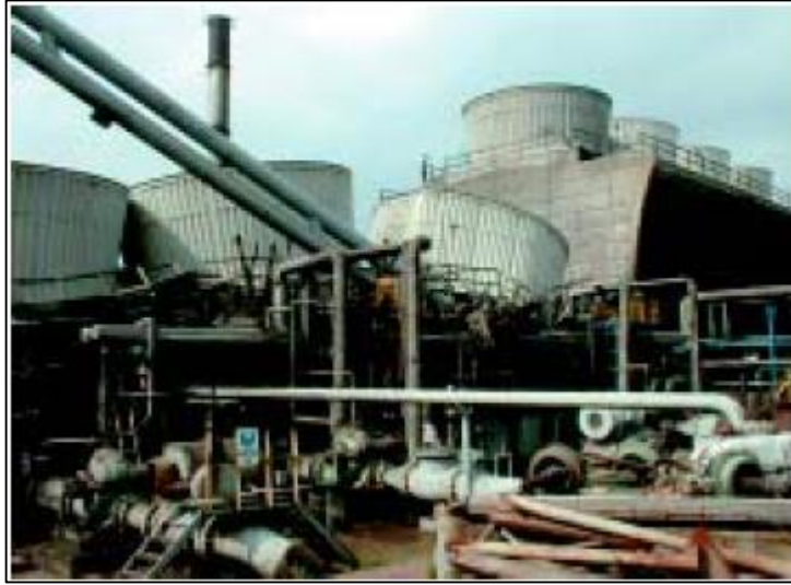
Şekil 2.2: Petkim petrokimya tesisinde yıkılan soğutma kulesi.
