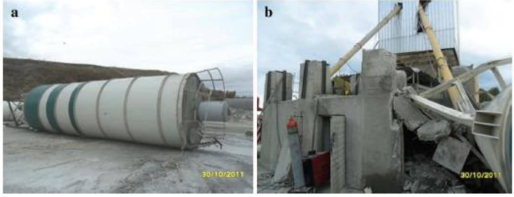
Şekil 2.3: a) Temel probleminden dolayı göçmüş bir silo 1, b) Temel probleminden dolayı göçmüş bir.
