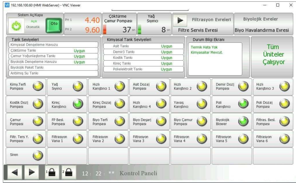
Şekil 5.8: Arıtma Tesisi PLC ekranı.
