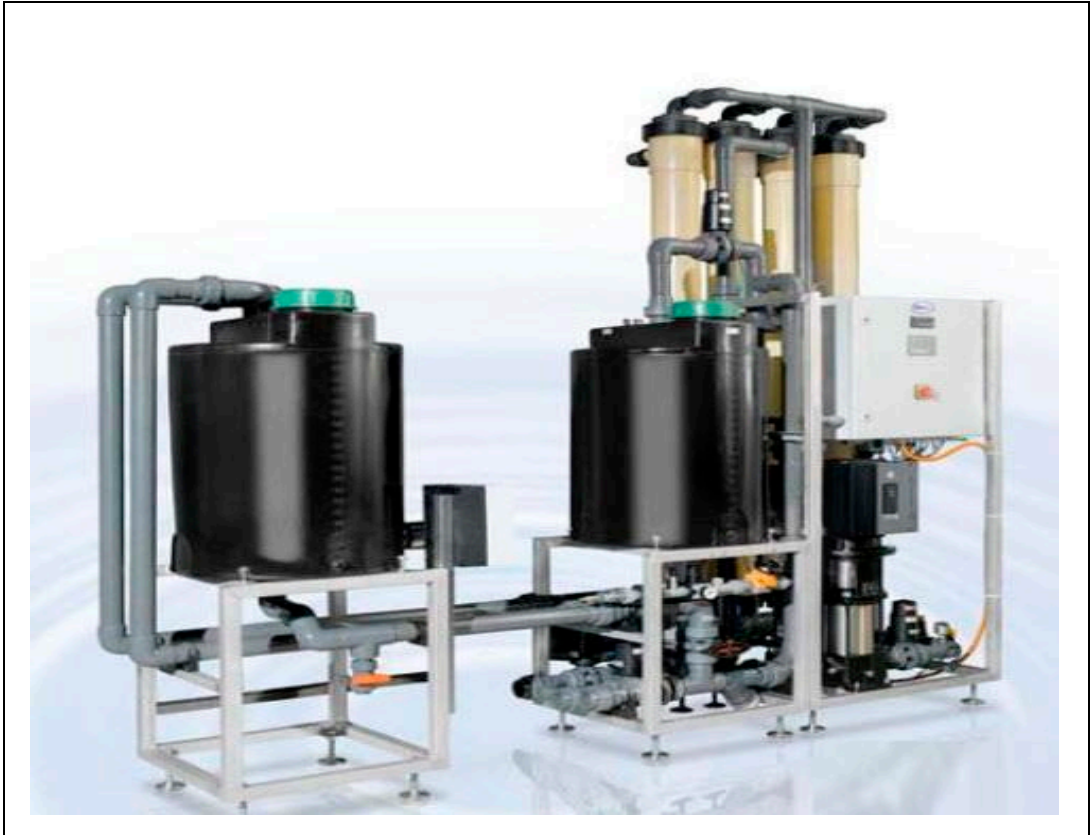
Şekil 2.2: Ultra filtrasyon Ünitesi genel görünümü.
