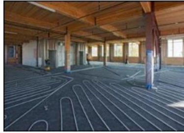
Resim 3.74: Döşeme arasındaki ısıtma ve soğutma hattı.
