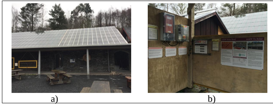
Resim 3.69: a) 1997 ve 2010 yıllarında uygulanmış ve elektrik üretilmesini sağlayan güneş panelleri, b) Güneş panellerinden elde edilen enerjinin takip edildiği pano ve sistemin işleyişini gösteren şemalar.
