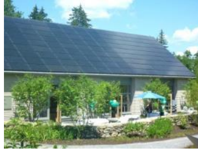
Resim 3.49: Ana binanın çatısında güney cephede bulunan güneş panelleri.
