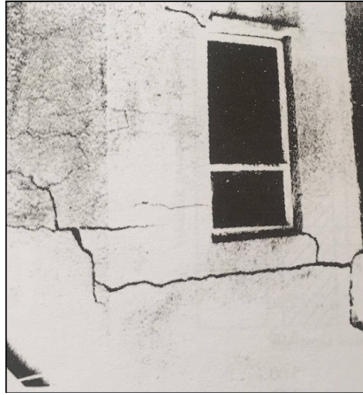
Şekil 2.1: Isı değişimleri sonucu oluşan kusur örneği.
