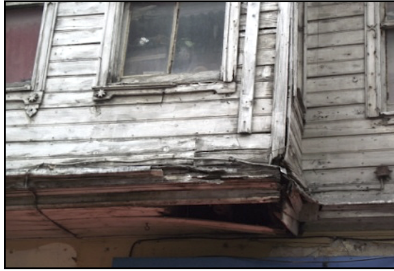
Şekil 2.5: Bakteri ve böceklerin üremesi sonucu oluşan hasarlar.
