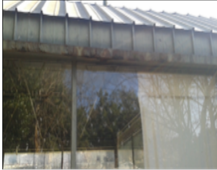
Şekil 2.3: Çelik ek nedeniyle oluşan korozyon sorunu.
