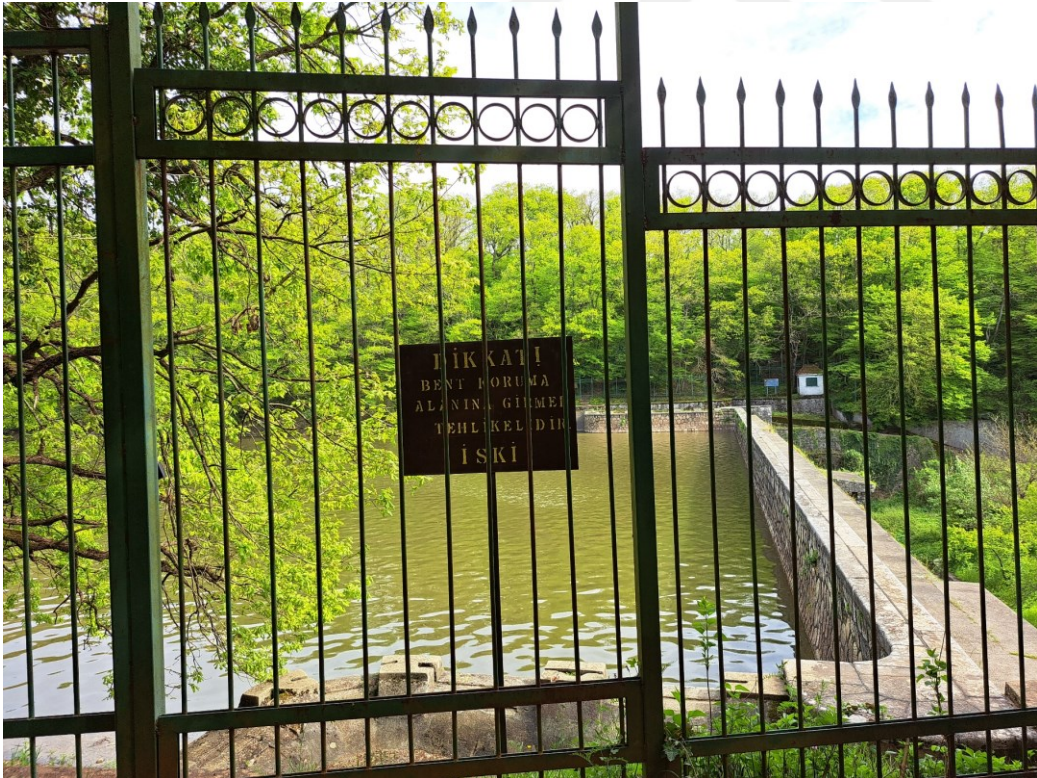
Şekil 4.15: Can güvenliği nedeniyle girişe kapalı olan Büyük Bent [Balcan, 2023].
