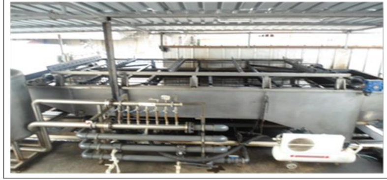
Şekil 2.25: DAF ünitesi (çözünmüş hava flotasyonu).
