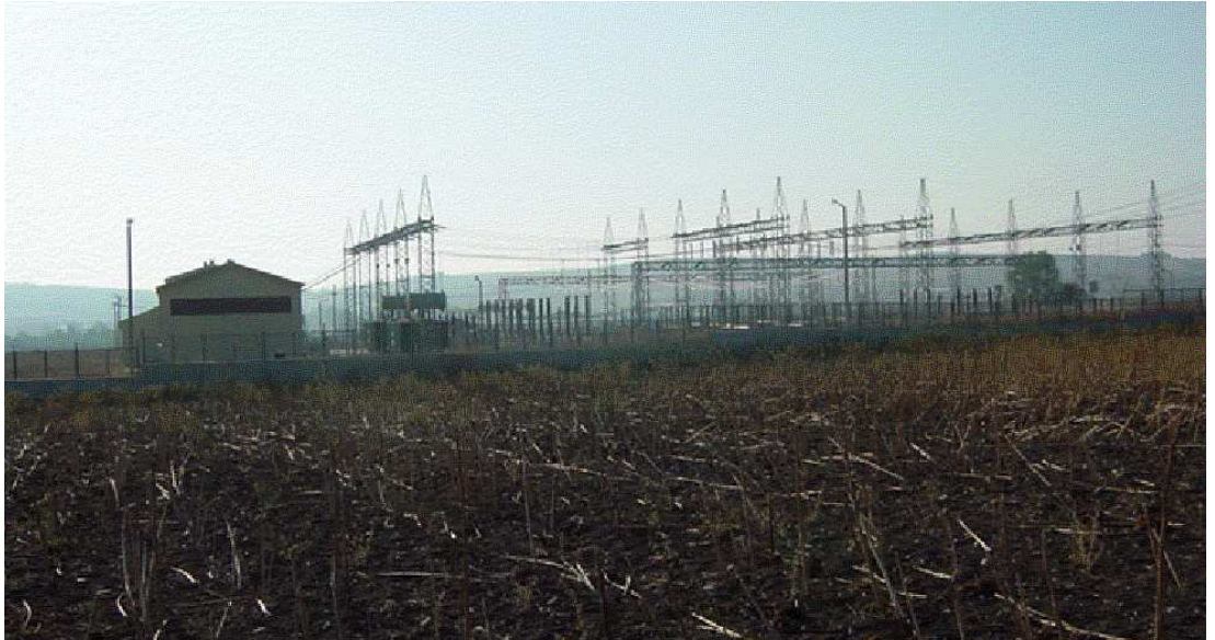
Şekil 4. 10. Ölçme Yapılan 154 kV'luk Trafo Merkezi
