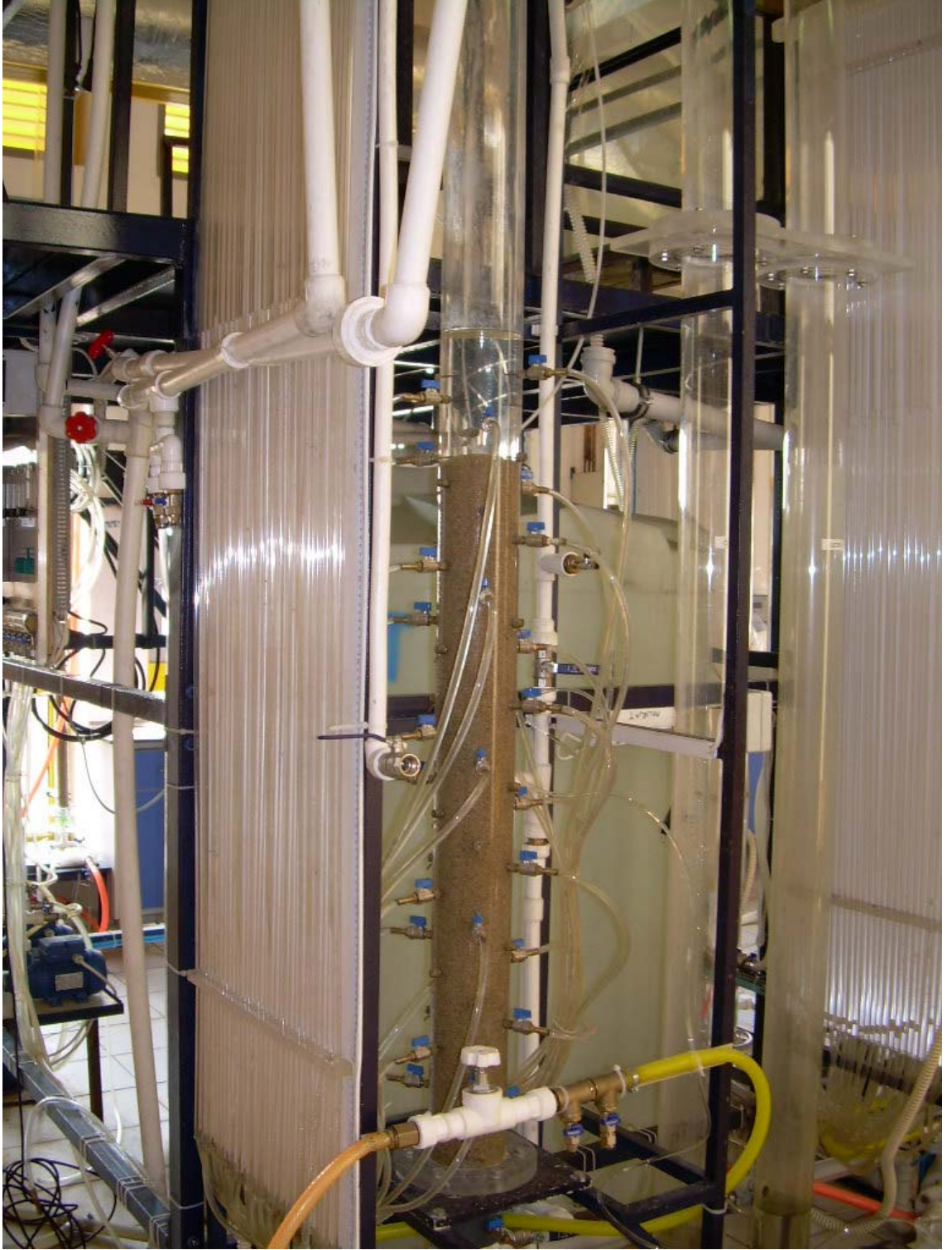
Şekil 4.8. Kum filtresi ve piyezometre borular
