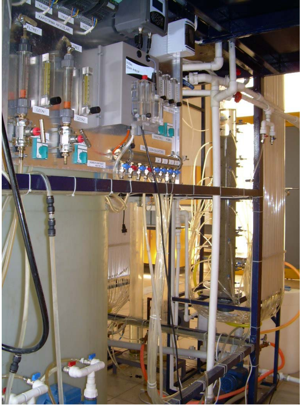
Şekil 4.3. Pilot tesis kontrol paneli
