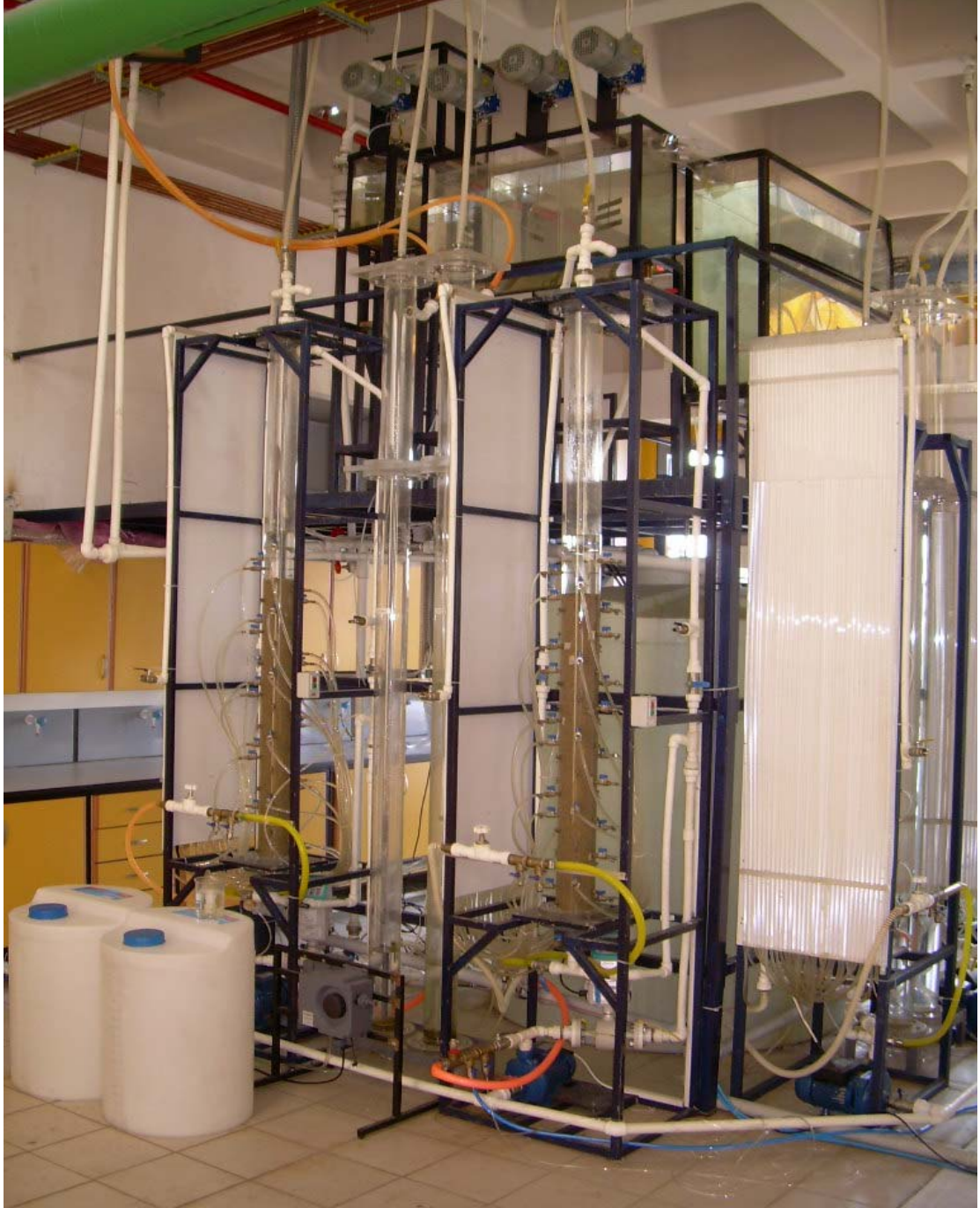
Şekil.4.2. Pilot tesisin genel görünüşü
