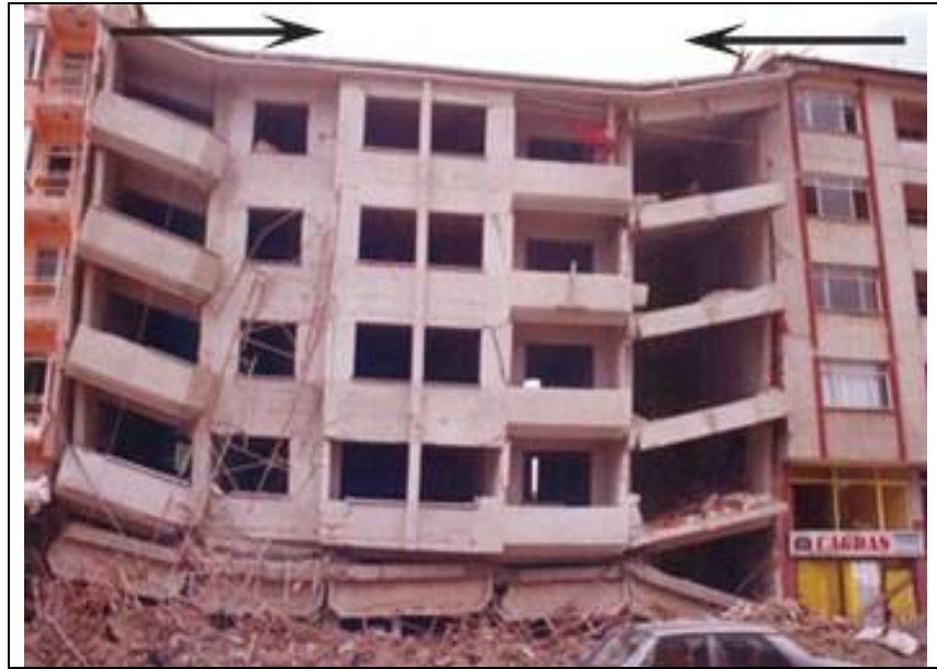
Şekil 3.8: Yetersiz dilatasyon derzinin yapılması sebebiyle yapıda meydana gelmiş çekiçleme etkisi ile oluşmuş çökme örneği.
