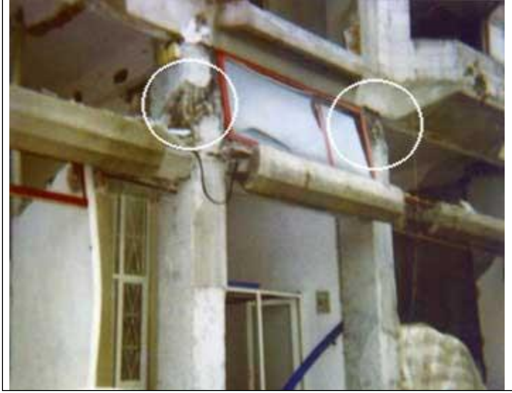
Şekil 3.6: Yetersiz sargı donatısından kaynaklanan kayma hasarı örneği. Kısa kolon etkisi ile kayma hasarının etkisi artmıştır.
