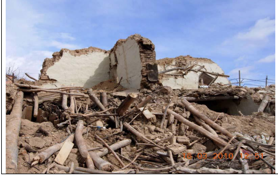
Şekil 3.17: Büyük bölümü yıkılmış iki katlı kerpiç ev örneği.
