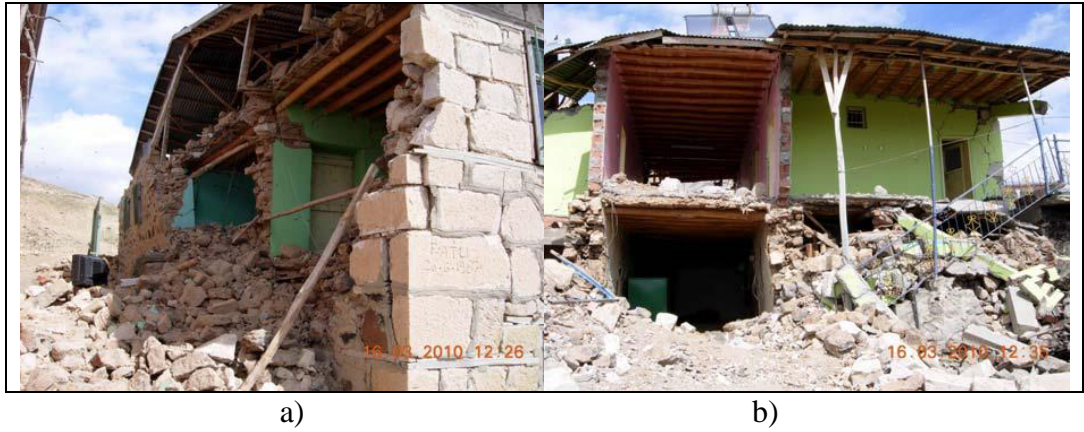
Şekil 3.22: a) Rijit diyafram sağlanamamasından oluşmuş düzlem dışı göçme örneği, sol yan görünüş, b) Düzlem dışı göçme ön görünüş.
