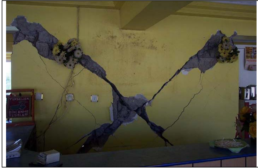
Şekil 3.11: Taşıyıcı duvarda meydana gelmiş kesme çatlakları örneği.
