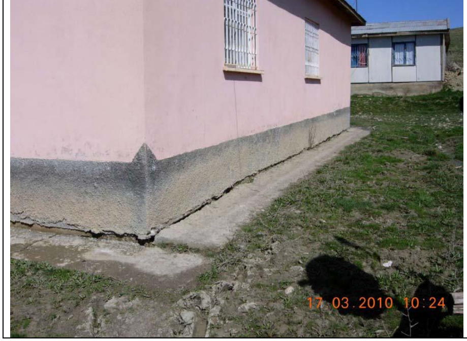
Şekil 3.23: Bir yapının temelinde farklı oturmalar sonucu oluşmuş çatlak örneği.
