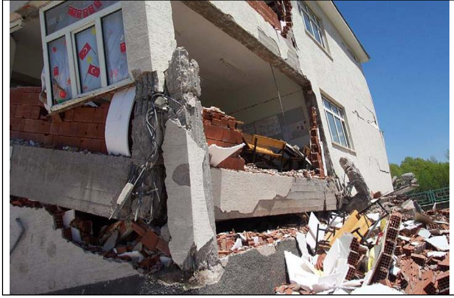
Şekil 3.12: Kolonda meydana gelmiş kesme hasarı örneği.
