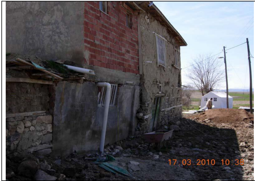
Şekil 3.20: Yumuşak kat mekanizması oluşmuş yapı örneği.
