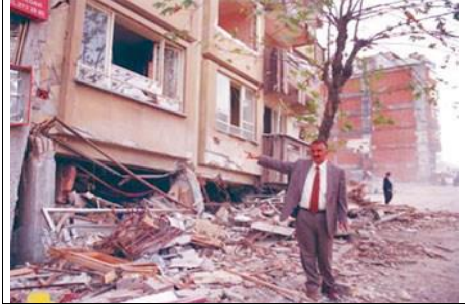
Şekil 3.7: Yumuşak kat etkisi ile yıkılmış bina örneği.
