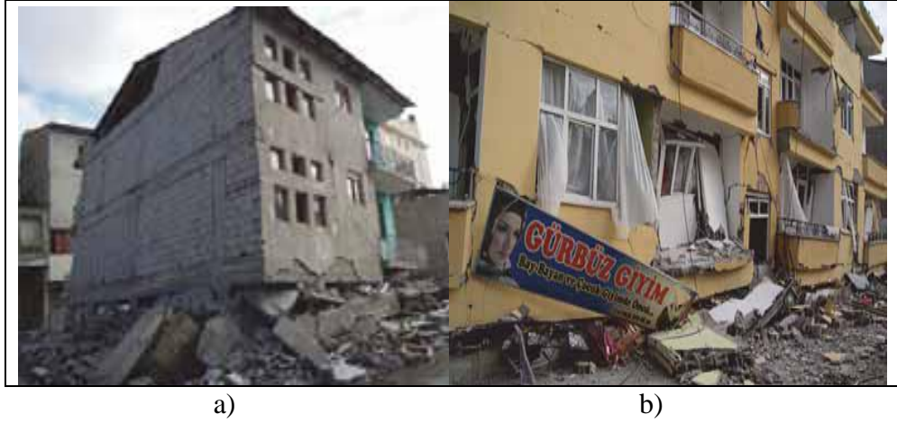
Şekil 4.7: a) 23 Ekim 2011 Van Depremi, yumuşak kat düzensizliği nedeniyle yıkılmış 3 katlı bina, b) Yumuşak kat düzensizliği nedeniyle yıkılmış 2 katlı bina.
