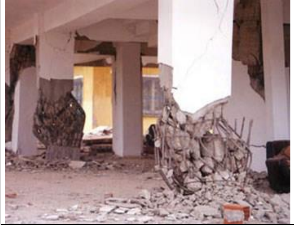
Şekil 3.5: Boyuna donatılarında burkulma ve betonda ezilme meydana gelmiş kolonlar.
