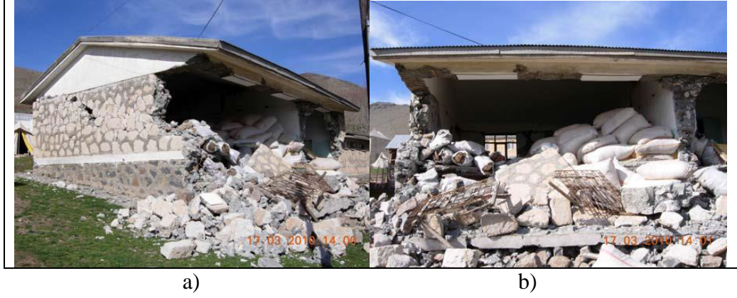
Şekil 3.21: a) Tek katlı binada duvarın düzlem dışı yıkılması örneği, sol yan görünüş, b) Düzlem dışı göçme ön görünüş.
