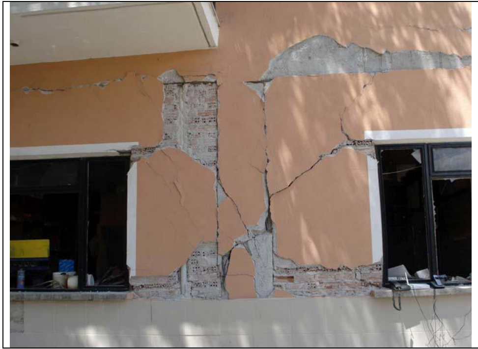
Şekil 4.16: Ağır yapısal hasar örneği; kısa kolon oluşmuş, dolgu duvarı olarak delikli tuğla kullanılmış.
