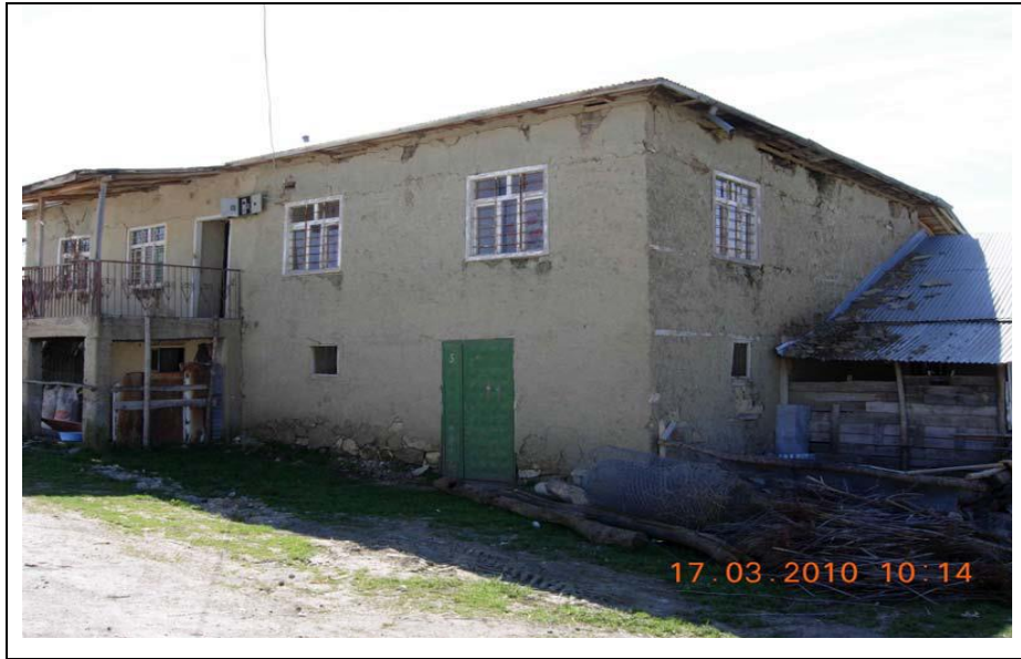
Şekil 3.16: İki katlı kerpiç evde döşemelerde mesnetlenme hatası sonucu meydana gelmiş hasar örneği.
