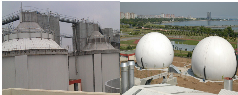
Şekil.4.6. Ataköy AAT anaerobik tanklar ve gaz depolama tankları
