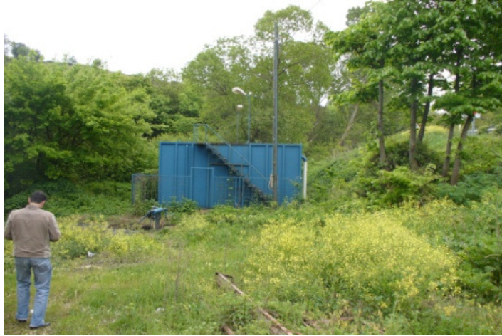
Şekil 3.16. Akalan Köyü Paket Arıtma Tesisi
