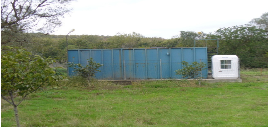
Şekil 3.18. Örencik Köyü Paket Arıtma Tesisi
