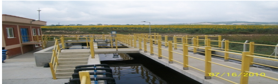
 ekil 3.17.   rc nl  k y  paket arıtma tesisi
