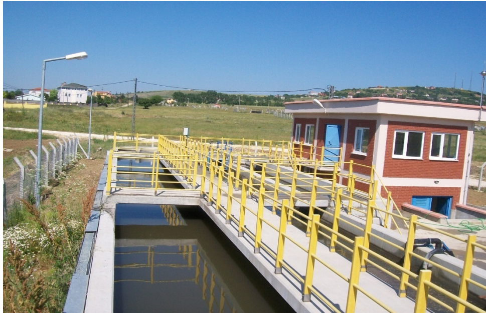
Şekil 3.14. Kestanelik köyü paket arıtma tesisi
