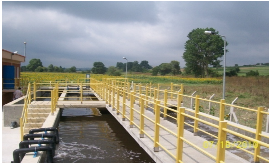
Şekil 3.15. Çanakça Köyü paket arıtma tesisi
