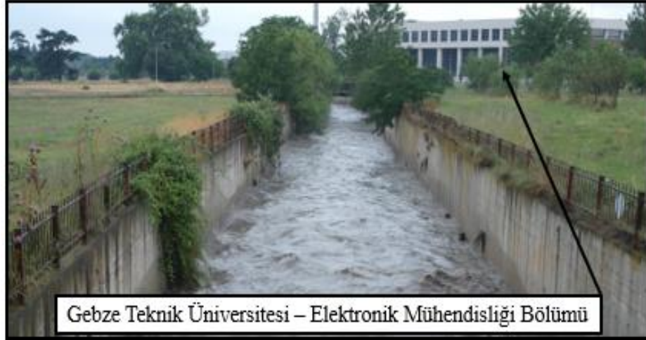
Şekil 4.12: Saz Deresi taşkın önleme amaçlı kıyı yapay yapılar.
