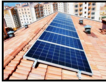
Şekil 5.22. Kayabaşı Uydukent’te çatılarda bulunan fotovoltaik paneller
