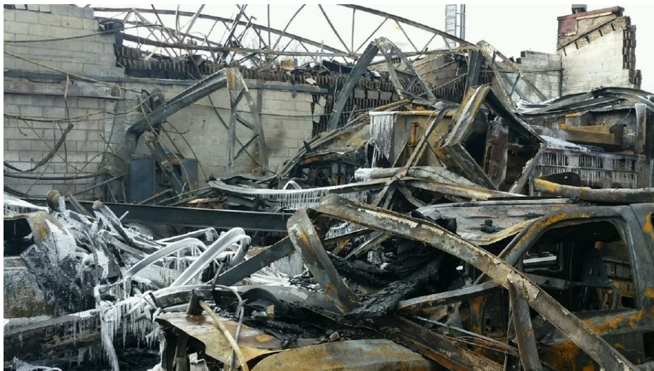
Şekil 4.3: Yangın sonucu göçen çelik taşıyıcı sistem.
