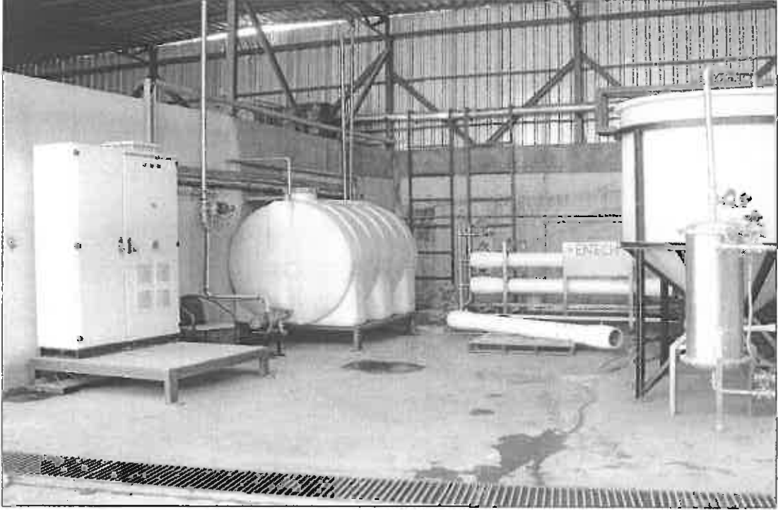
Şekil 3.3: Pilot tesis, temiz su tankı.
