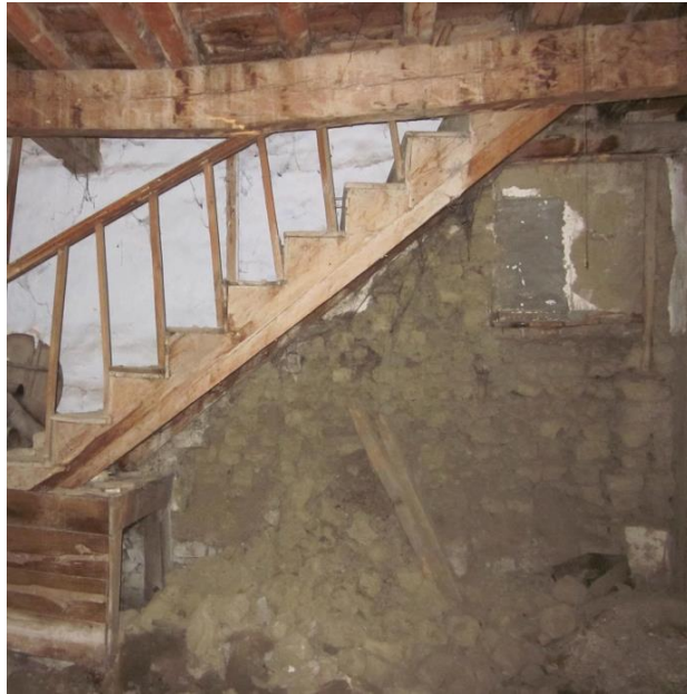
Şekil 4.75: B01 nolu oda yıkılan duvar, 2019.
