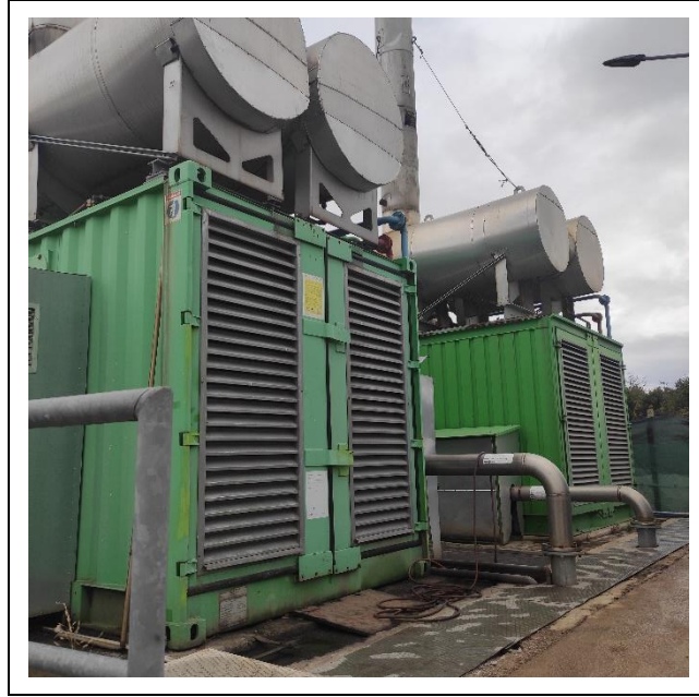
Şekil 3.8: Dilovası Tesisi enerji üretiminde kullanılan gaz motorları ünitesi.
