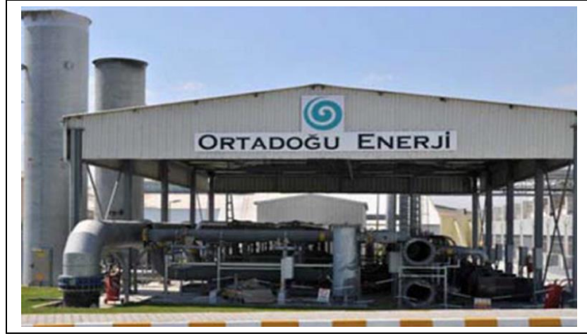
Şekil 3.3: Odayeri basınçlı hava üfleyici ( blower ) ve yakma bacası.
