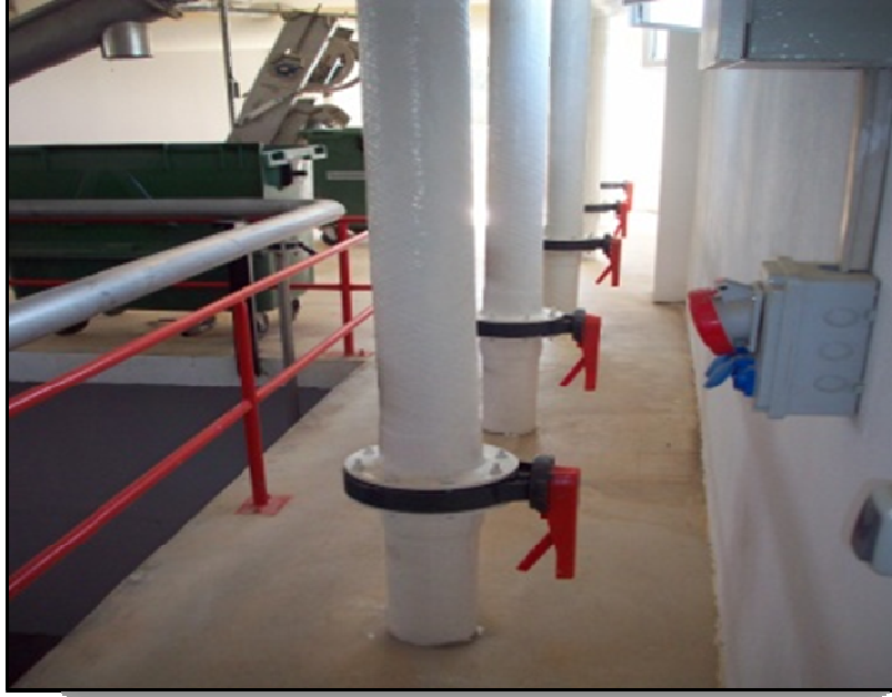
Şekil 3.23. Dengeleme binası koku giderme ünitesi
