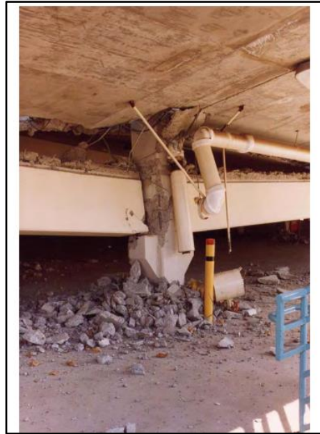
Şekil 4.1:Northridge depreminde prekast kolon göçmesi.
