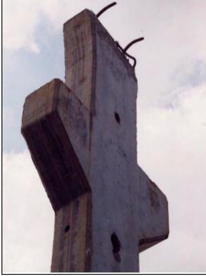
Şekil 4.11: Yetersiz kolon kiriş birleşim detayı hasarları.
