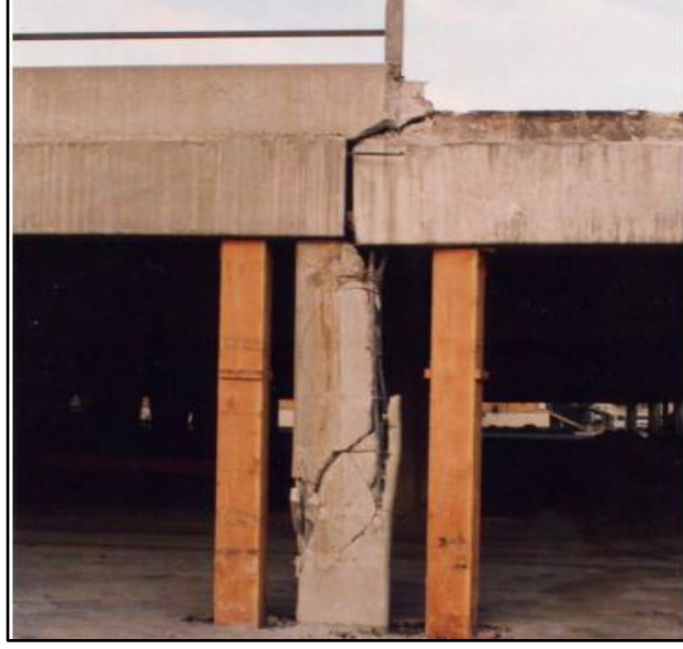
Şekil 4.13: Yetersiz kesme dayanımı hasarları.
