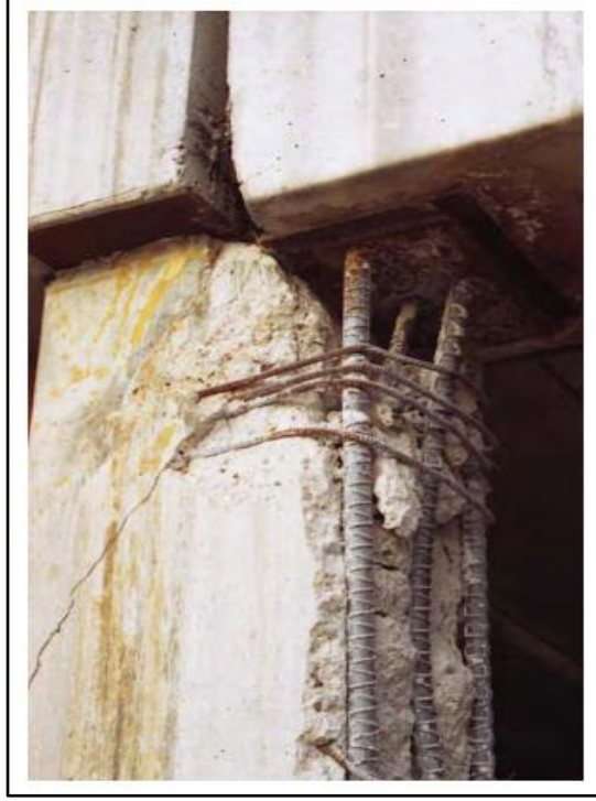
Şekil 4.15: Pimli bağlantı detaylarının yanlış uygulanması.
