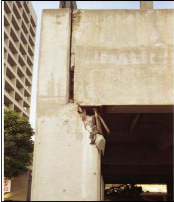
Şekil 4.14: Pimli bağlantı detaylarının yanlış uygulanması.
