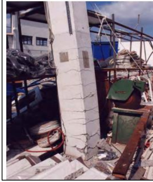
Şekil 4.4: Betonarme kolonun Kocaeli depremindeki sünek davranışı.
