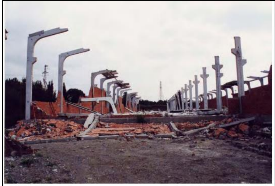
Şekil 4.16: Rijit duvarlardan meydana gelen hasarlar.
