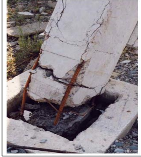
Şekil 4.2: Prekast kolon temel birleşiminde meydana gelen kesme hasarı.
