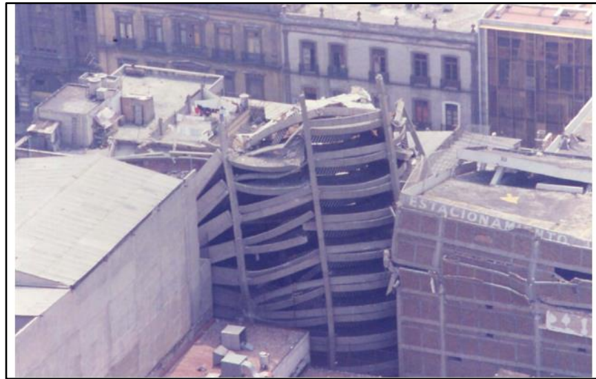
Şekil 4.18: Yetersiz derz boşluklarından meydana gelen hasarlar.
