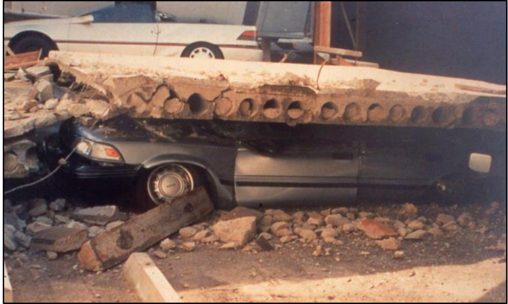
Şekil 4.6: Yetersiz diyafram bağlantı tasarımından meydana gelen hasarlar.
