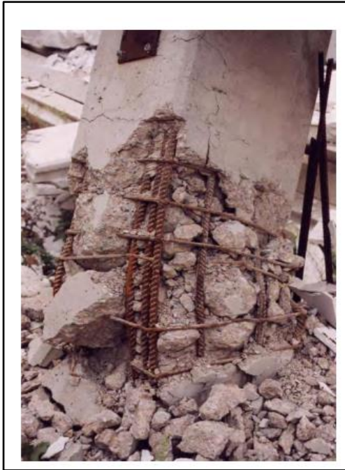
Şekil 4.3: Prekast kolonda meydana gelen kesme hasarı.
