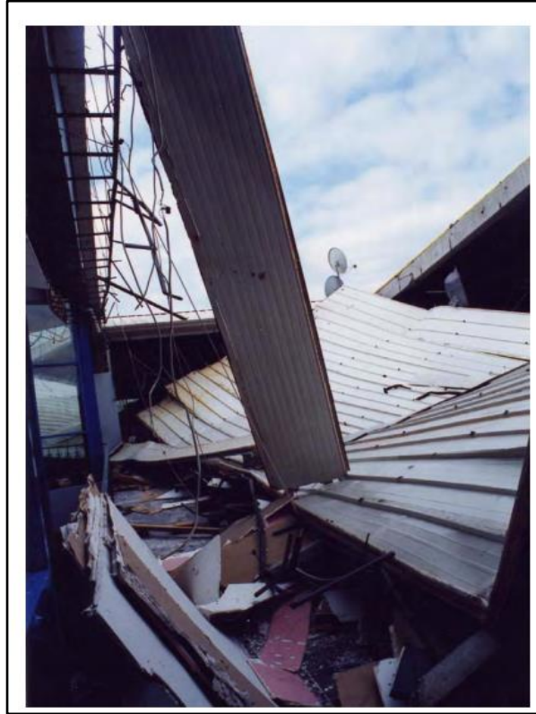
Şekil 4.8: Yetersiz diyafram tasarımdan meydana gelen hasarlar.
