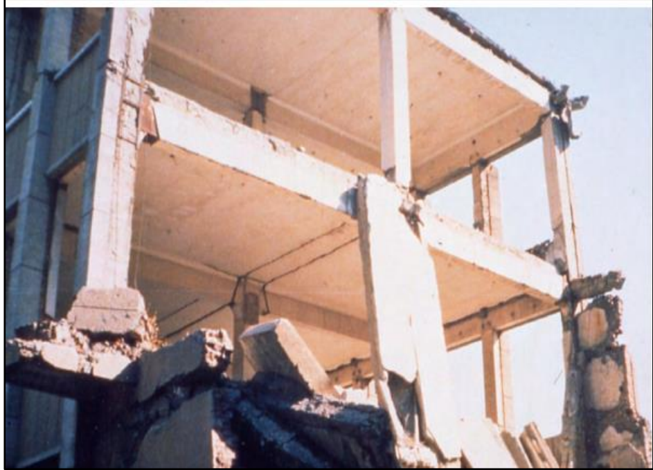
Şekil 4.9: Yetersiz kolon kiriş birleşim detayları hasarları.
