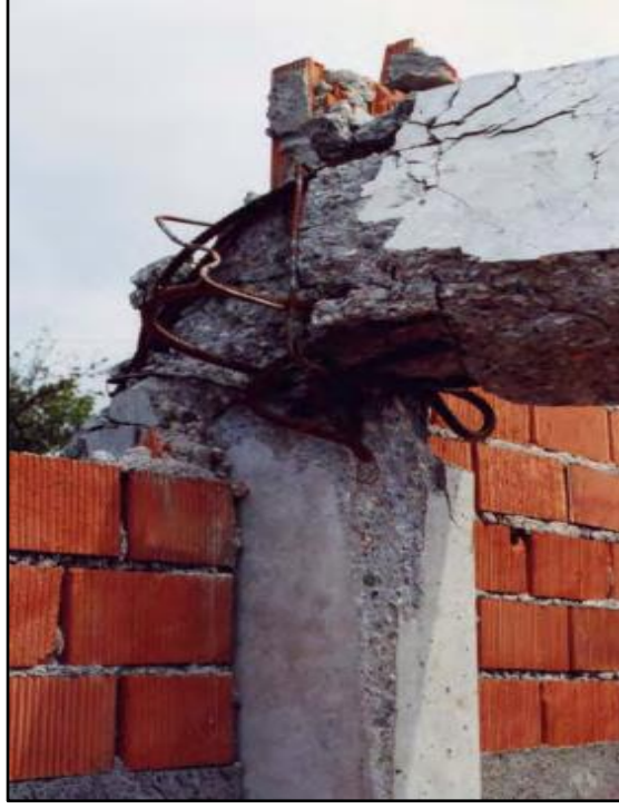
Şekil 4.17: Rijit duvarlardan meydana gelen hasarlar.
