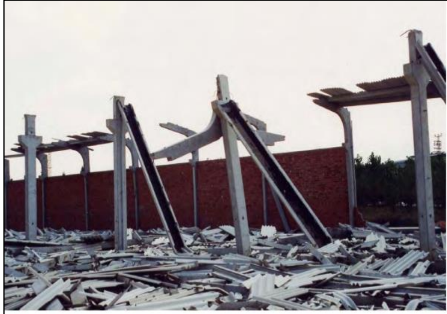
Şekil 4.12: Yetersiz kolon kiriş birleşim detayı hasarları.
