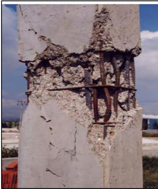
Şekil 4.5: Prekast kolon yetersiz donatı detaylandırması hasarları.
