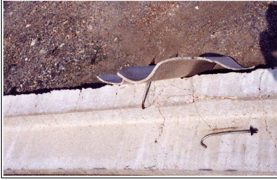
Şekil 4.7: Yetersiz diyafram tasarımından meydana gelen hasarlar.
